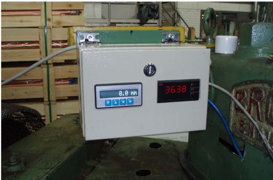
Kuva 23. Digitaaliset näytöt asennettuna ja käyttövalmiina kotelossaan.
