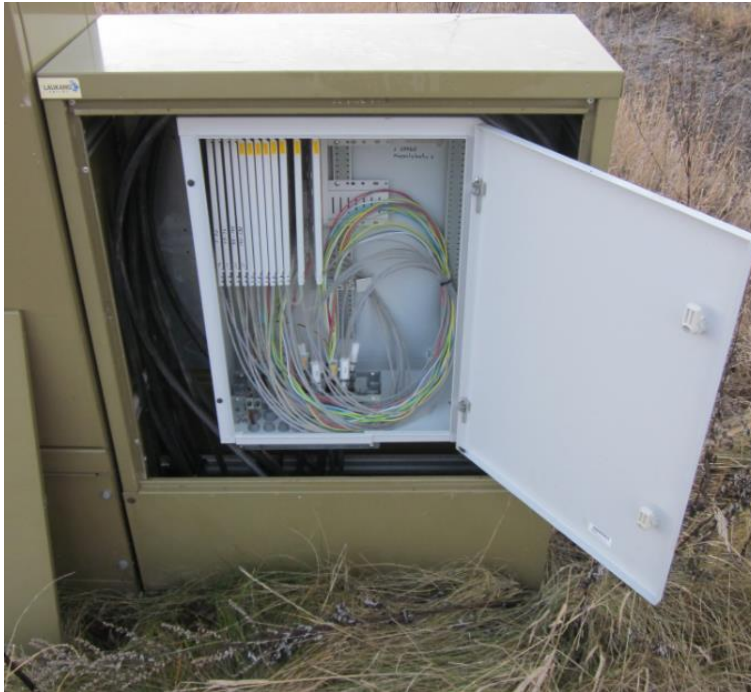
Kuva 3. Valokuitujakokaappi jossa suuri syöttökaapeli ja useita tilaajakaapeleita.
