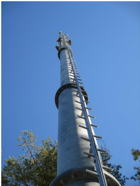
KUVA 9. Turvakisko putkimastossa (Honkala 2015-10-11.)
