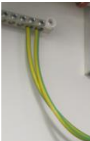
KUVA 66. Maadoituskaapeli MK16 (Honkala 2015-10-11.)
