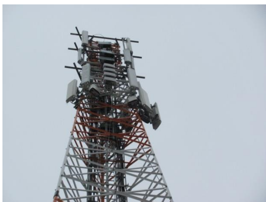
KUVA 60. Matkaviestinverkon antennejä ja radioyksiköitä (Honkala 2015-9-18.)
