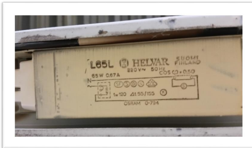
KUVA 6. Loisteputkivalaisimen kuristin (HELVAR L65L)
