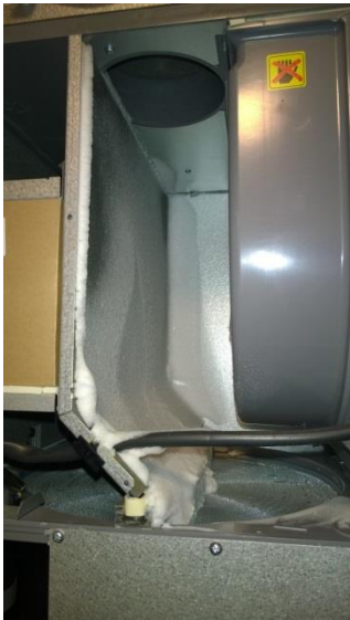
KUVA 1. Jäätynyt lämmönsiirrin (Kuvaaja Jukka-Pekka Kukkola)
