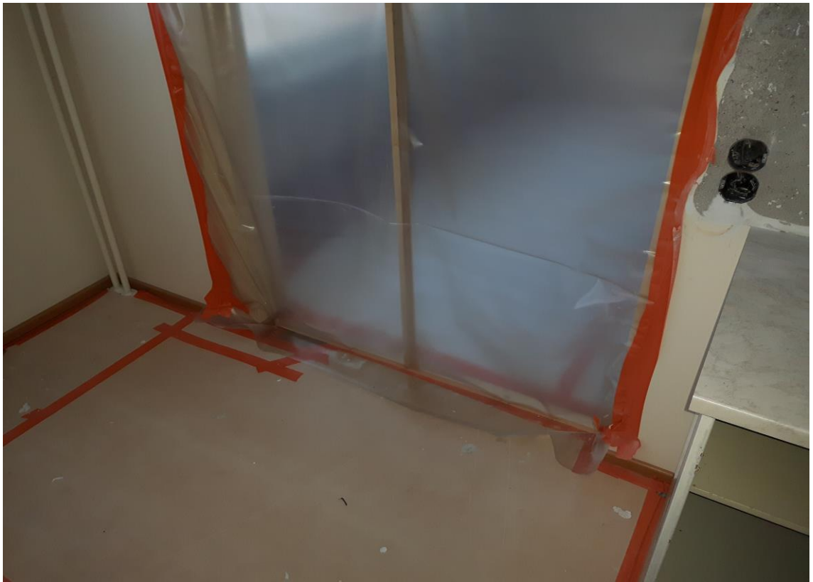
KUVA 4. Osastoinnin teippaukset puutteelliset (Hyryläinen 2016)
