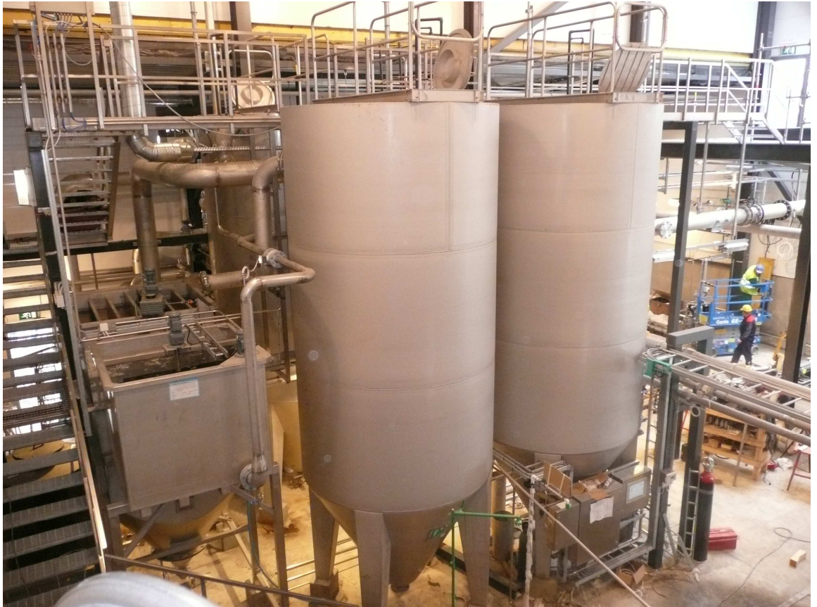
Kuva 23. Dynasand—hiekkasuodattimet ja vieressä lamella asennettuina. [7.]
