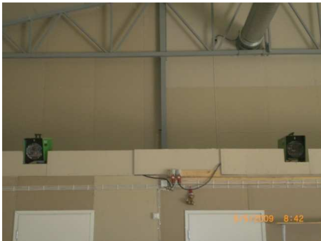
Kuva 2.4 Kierrätysilmapuhaltimet ja aksiaalipuhallin poistokanavassa
