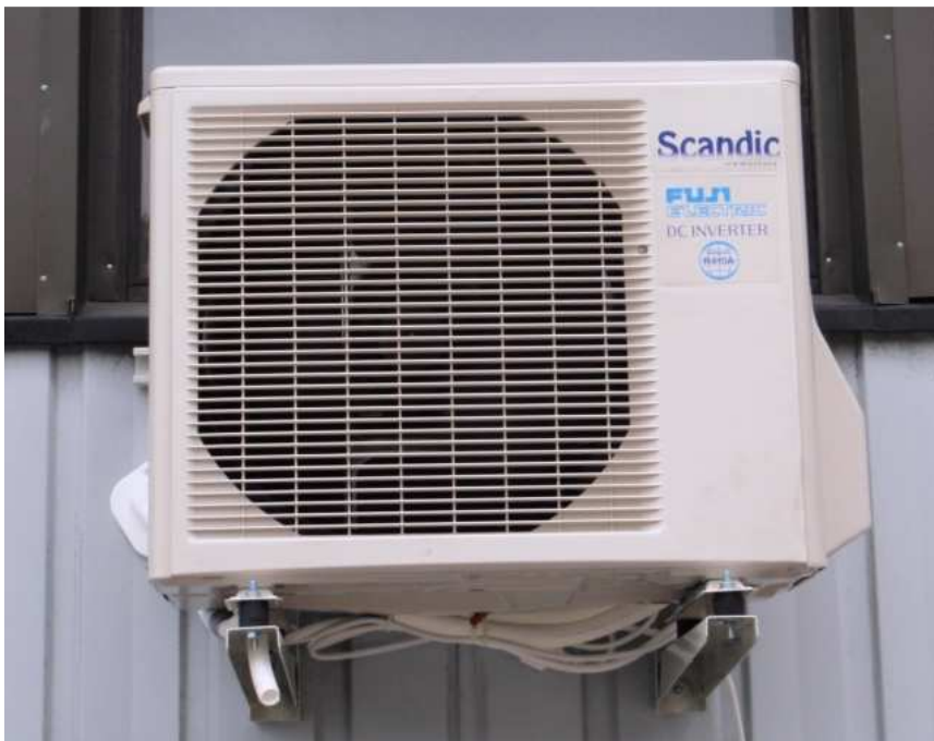
Kuva 6.3 Fuji Electricin ASYA 12LC ulkoyksikkö
