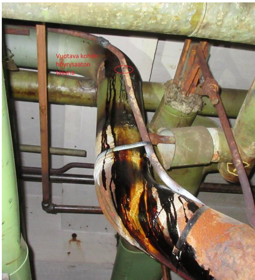
Kuva 12. Vuotava amiinilinja sekä vieressä kulkeva hörysaattolinja
