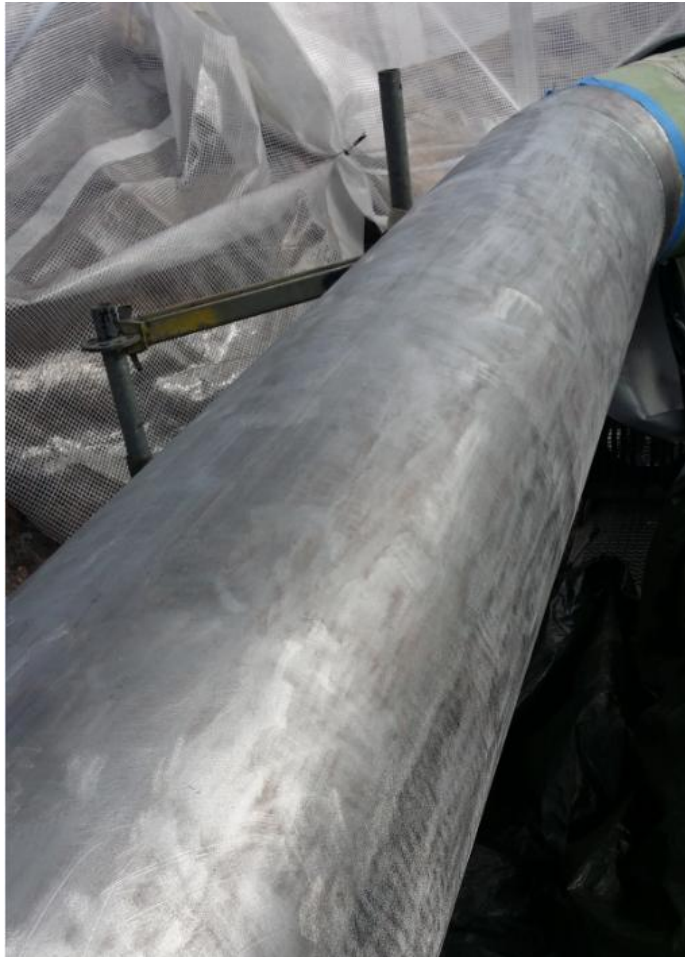
Kuva 4. SSPC-SP-10 -pinnanlaatu hiiliteräsputkessa
