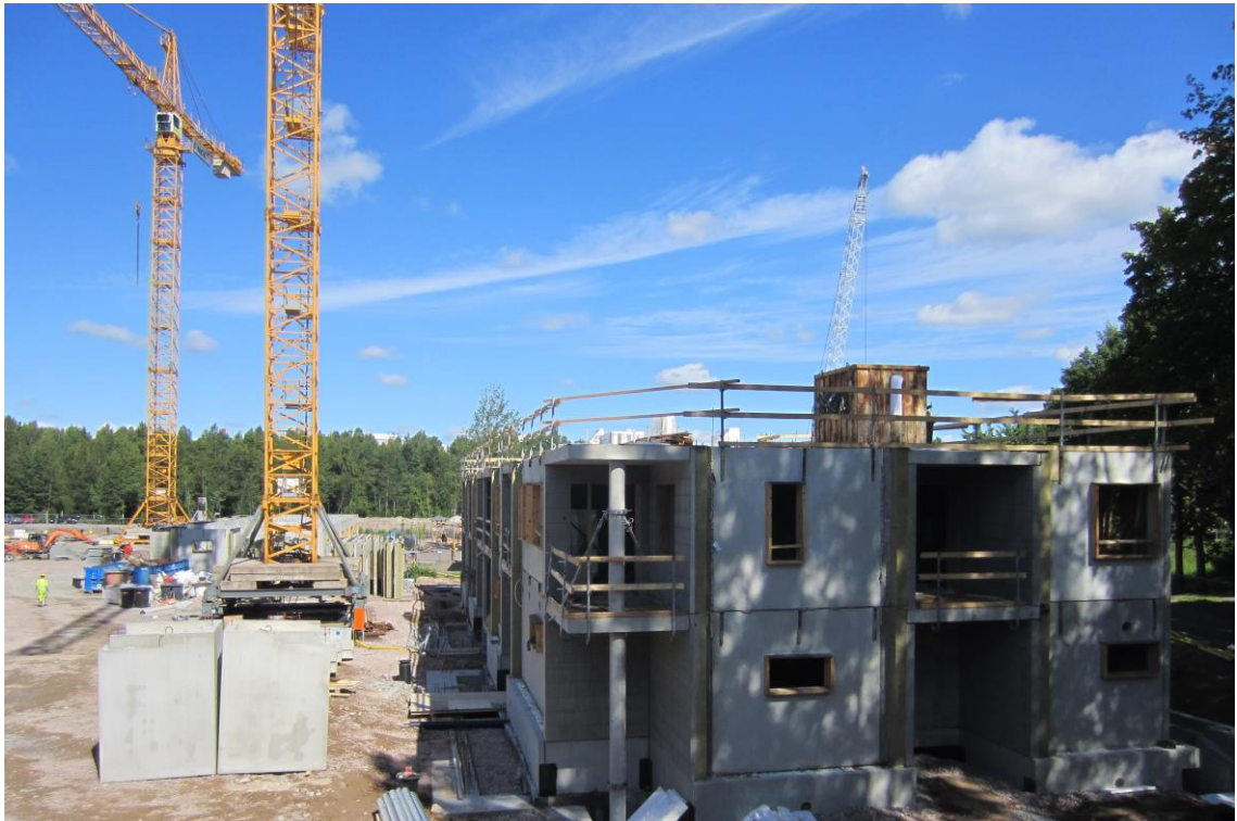
Kuva 1. VAV Loiskekuja 1 ensimmäisen rungon asennustyö käynnissä. Kuvassa näkyy lisäksi ylimmän kerroksen putoamissuojaus asennettuna.
