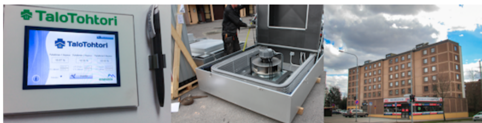
Kuva 7. As Oy Pohjolankatu 18-20, lämmöntalteenottojärjestelmä.
