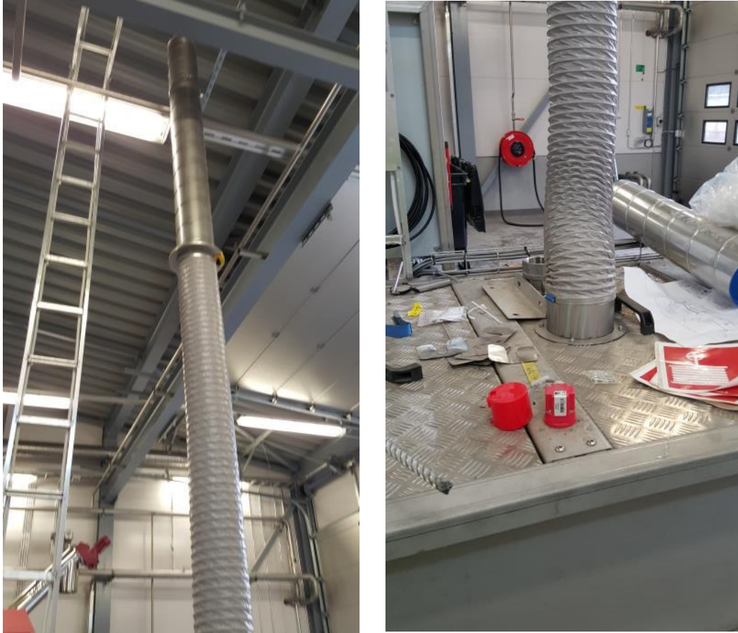
Kuva 20. Lietelavan kohdepoiston liityntä poistoilmakanavaan.
