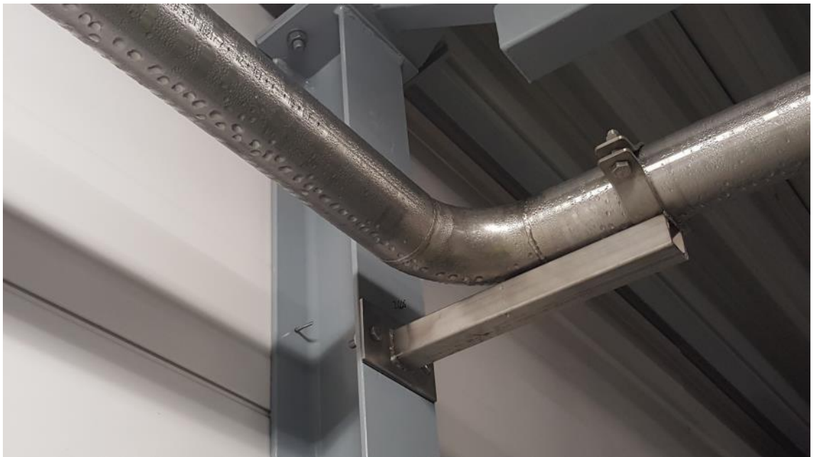
Kuva 31. Hallitsematon kosteuskuorma vedenkäsittelytiloissa aiheuttaa kondenssia.
