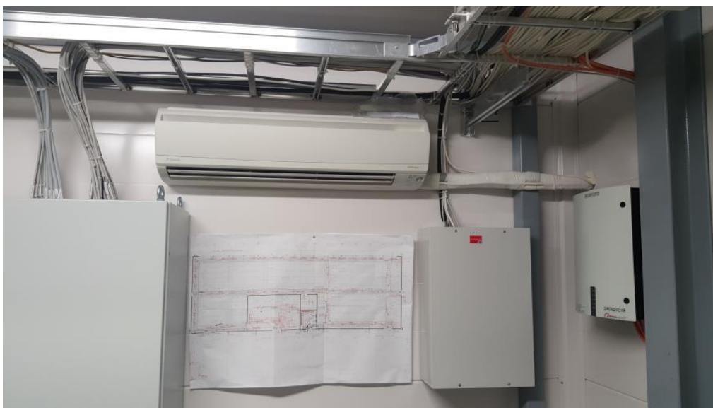
Kuva 11. Erään jätevedenpuhdistamon sähköpääkeskuksen jäähdytysratkaisu
