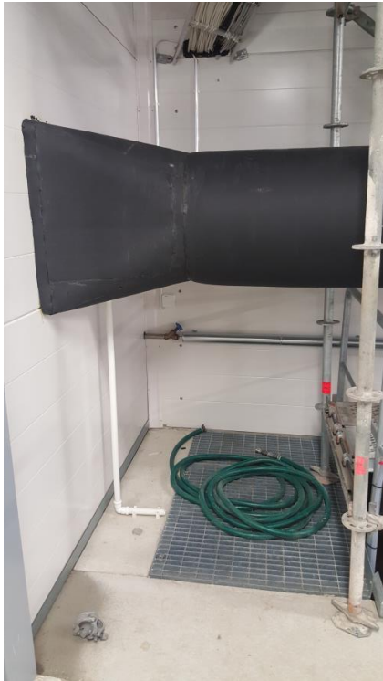
Kuva 26. Kondenssiveden poisto asennettuna raitisilmakanavaan.
