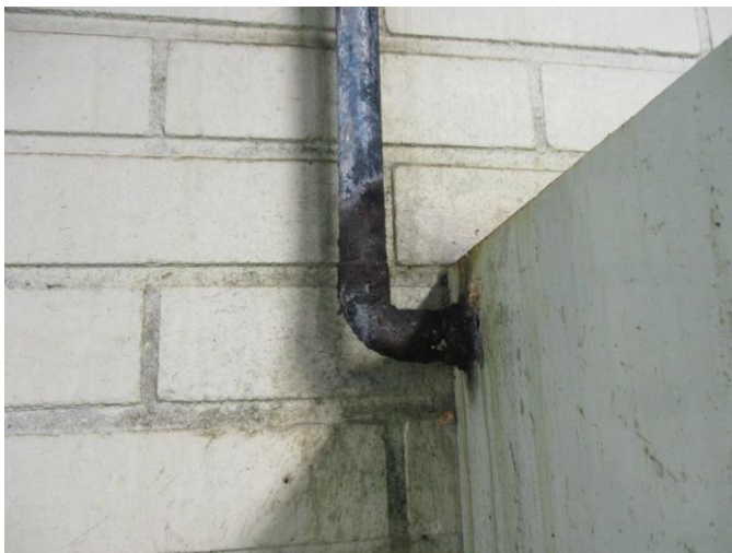
Kuva 28. Hapettunut kupariputki jätevedenkäsittelytiloissa.
