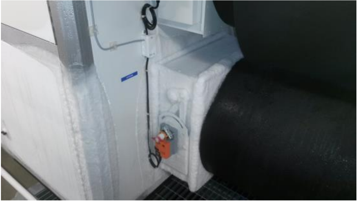
Kuva 24. Jäätynyt ilmanvaihtokone esimerkkikohteessa.
