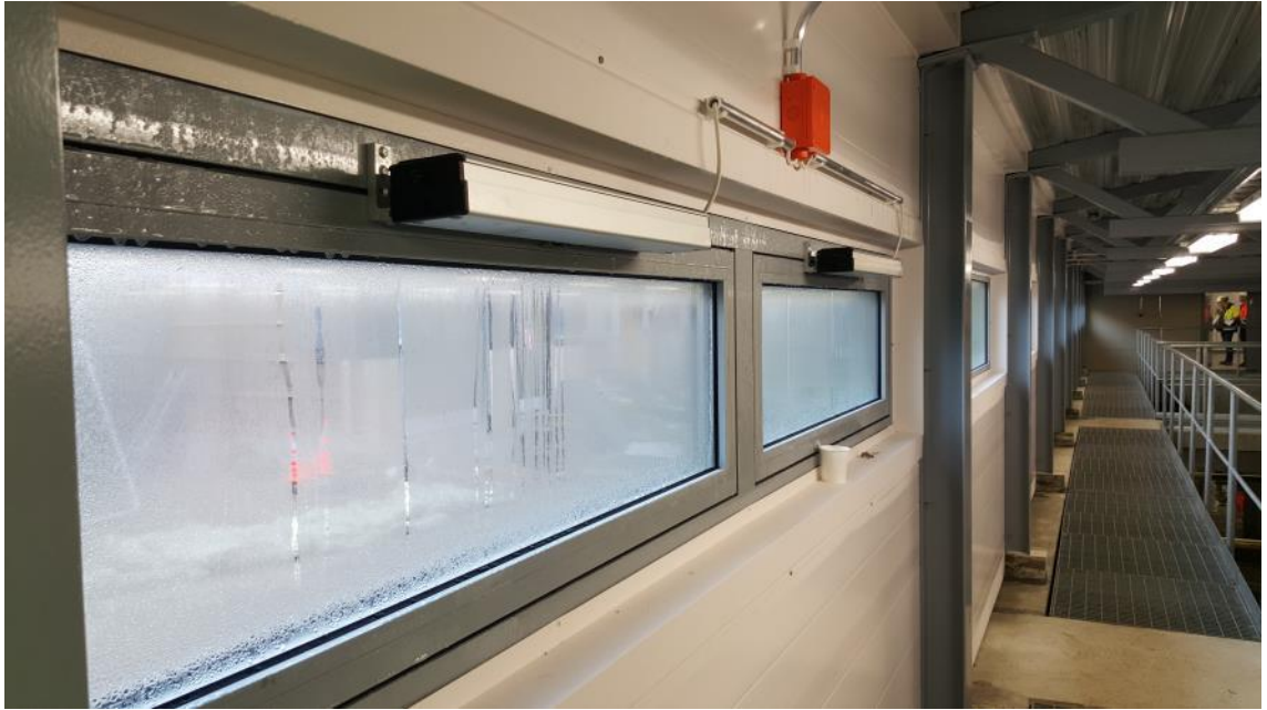
Kuva 30. Ilmanvaihdon toimiessa väärin, kosteus tiivistyy rakenteiden pinnoille.
