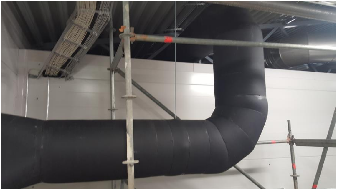
Kuva 29. Pellittämätön raitisilmakanava on herkkä vaurioille.
