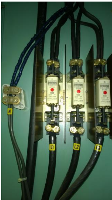
Kuva 17. Hapettuneita liittimiä sähkötilassa (Ramboll Finland Oy, 2016).
