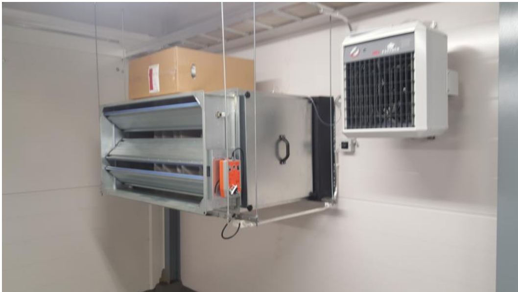
Kuva 13. Erään puhdistamon muuntamotilan korvausilmanottojärjestelmä + KIK
