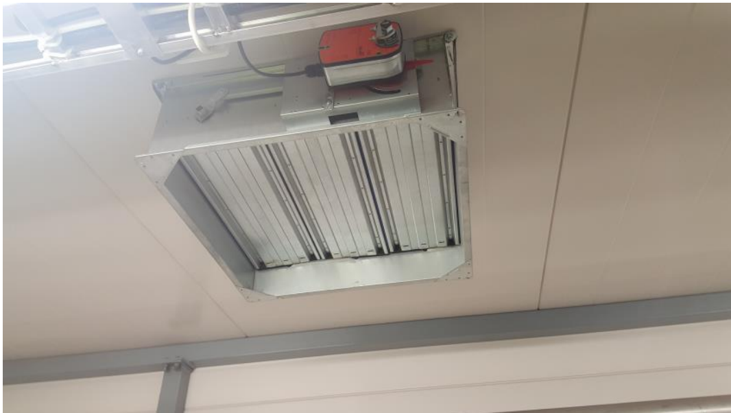
Kuva 14. muuntamotilan yllilämmönpoistojärjestelmä, toimii yhdessä kuvan 13 raitisilman oton kanssa
