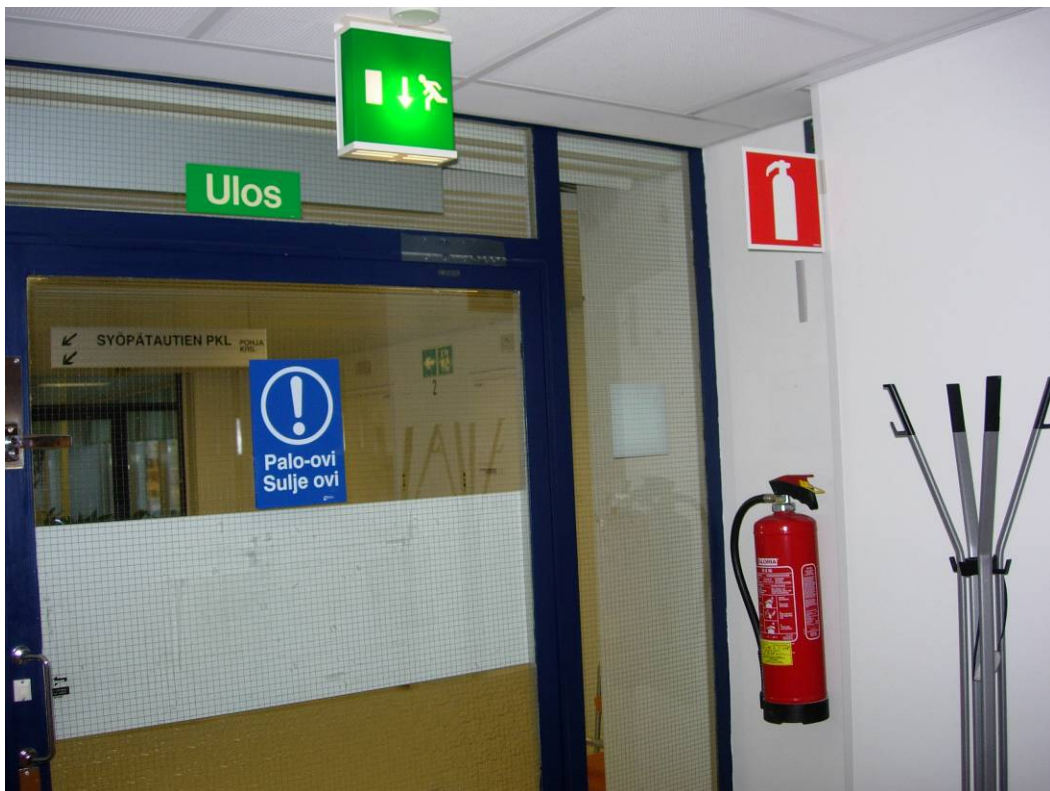
Kuva 9. Palo-ovi, Akustolevykatto ja poistumistievalaisin
