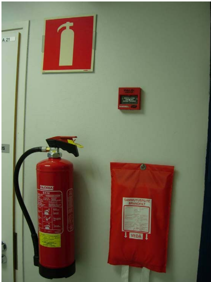
Kuva 3. Käsisammutin, sammutuspeite, paloilmoinpainike sekä sammuttimen ilmoituskyltti
