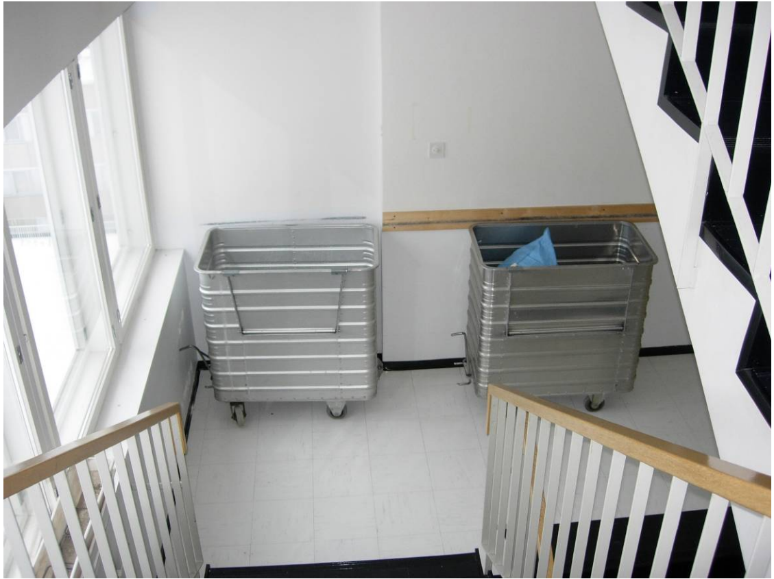
Kuva 7. Varauloskäytävälle sijoitettua tavaraa
