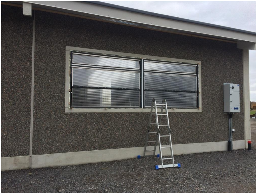
Kuva 13. Tuloilmaluukuina vaijereilla säädettävät säleikkunat
