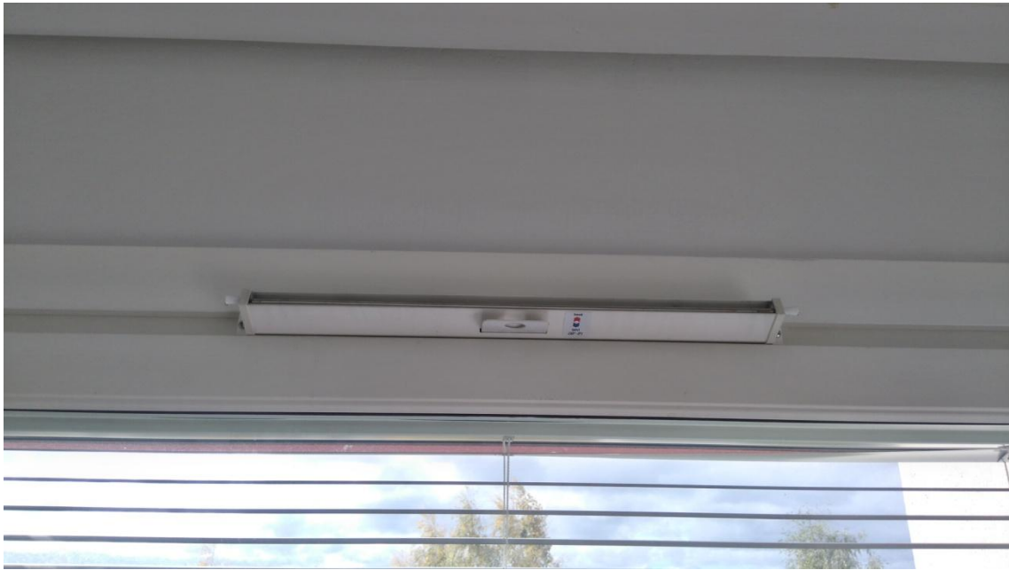
KUVA 11. H 80 huoneiston tuloilmaikkuna korvausilmaventtiilillä
