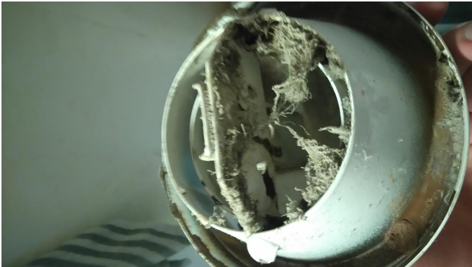
KUVA 2. H 80 -huoneiston pesuhuoneen KS 100 -päätelaitte
