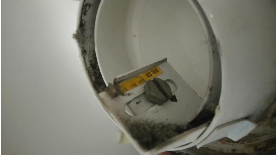
KUVA 1. H 66 -huoneiston pesuhuoneen KS 100 -päätelaitte
