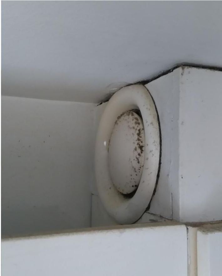
KUVA 3. H 60 -huoneiston keittiön KK 150 -päätelaitte liesikuvun yläpuolella
