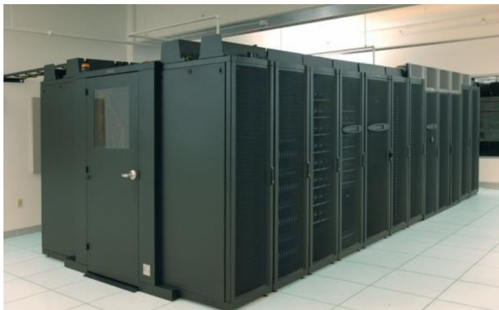
KUVA 4 Esimerkki rivipohjaisesta jäähdytyskaapista
