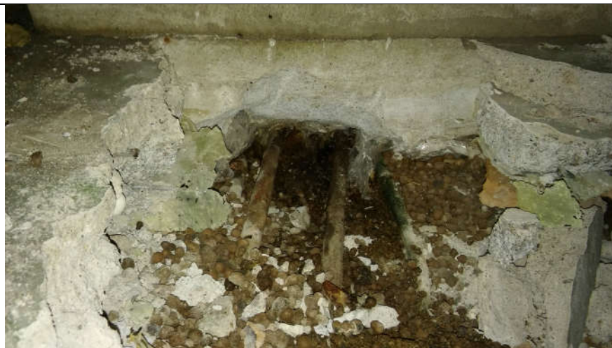
Kuva 7. Vuotokohta löytynyt saunan ja pesuhuoneen välisen seinän alta, merkkikaasun ja kuulolaitteen avulla.
