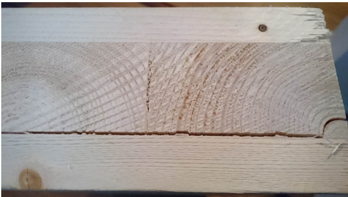
Kuva 8. Päädyn matkalla halkeama liimasauman vieressä
