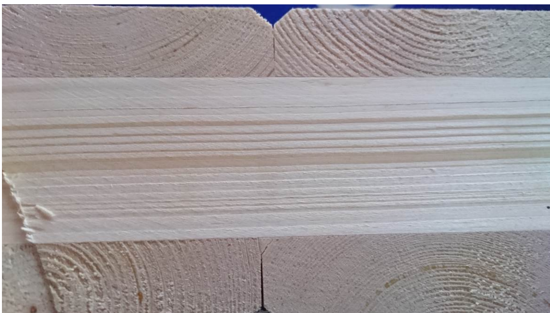
Kuva 7. Testikappaleen ulkolamellien välissä rakoilua
