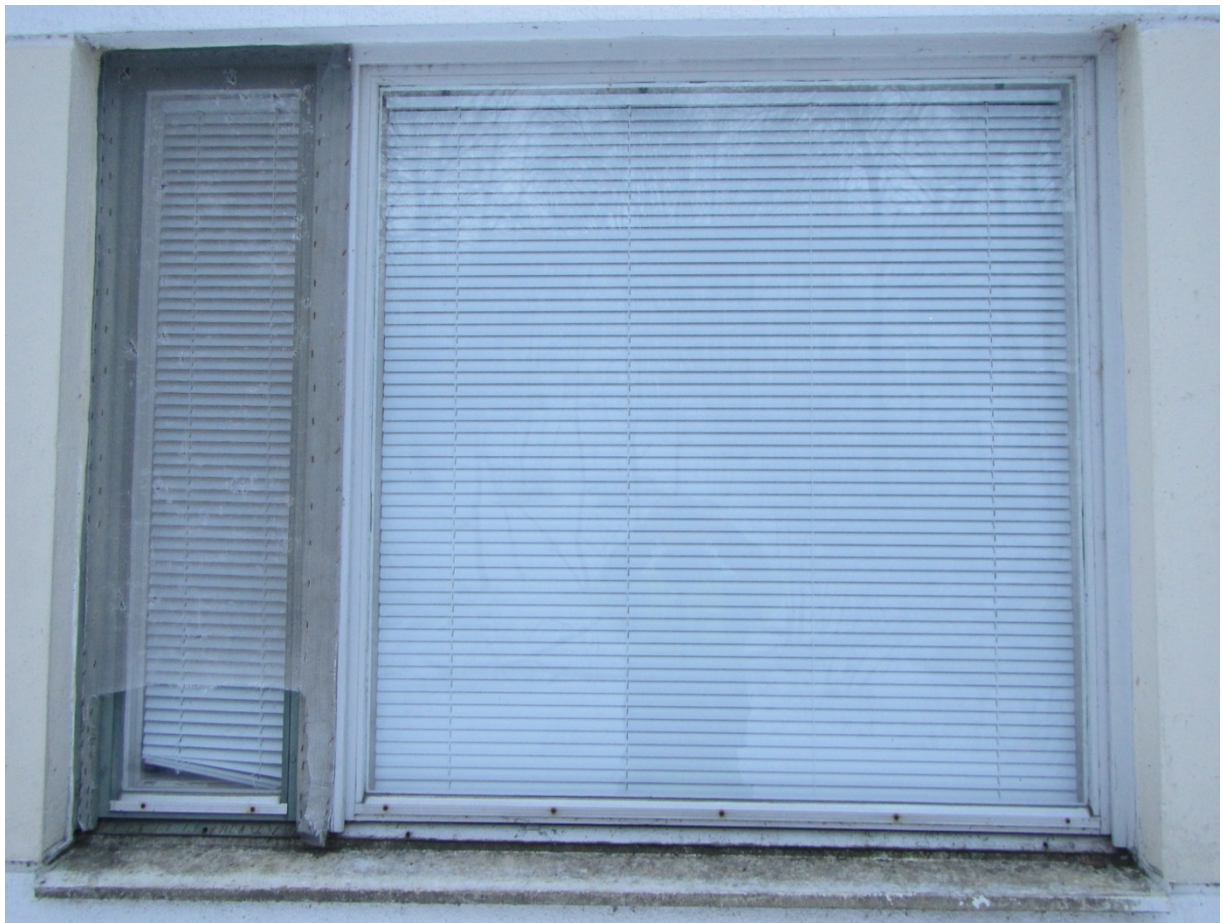
Kuva 17. Ikkunoiden vesipellityksien kaadot ovat melko vähäisiä. Pohjoisen puoleisella seinällä ikkunoissa on runsaasti orgaanista jälkeä.
