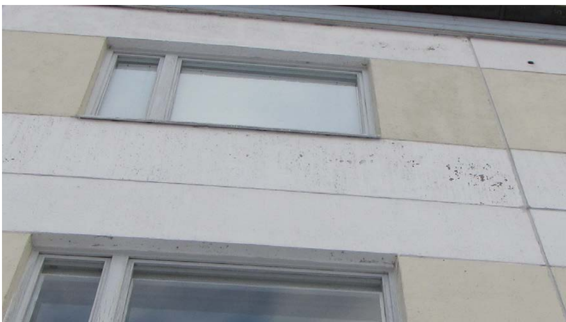
KUVA 6. Julkisivuelementtien näkyvät vauriot ovat lähinnä maalipinnan hilseilyä.
