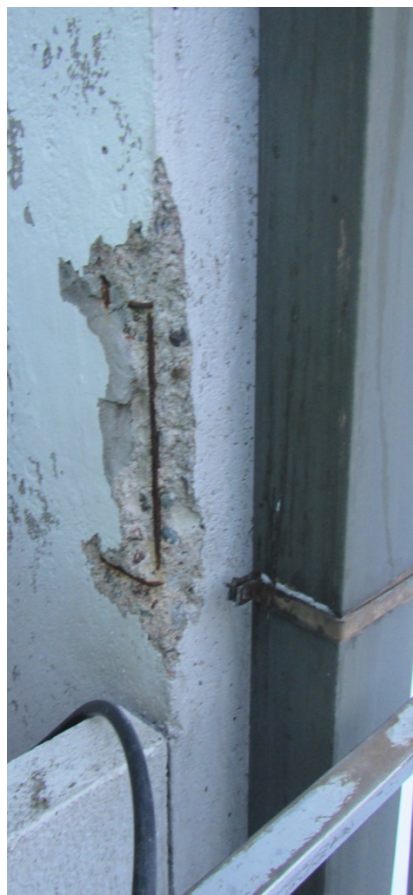
Kuva 9. Parvekepielissä on joitakin yksittäisiä korroosiovaurioita.
