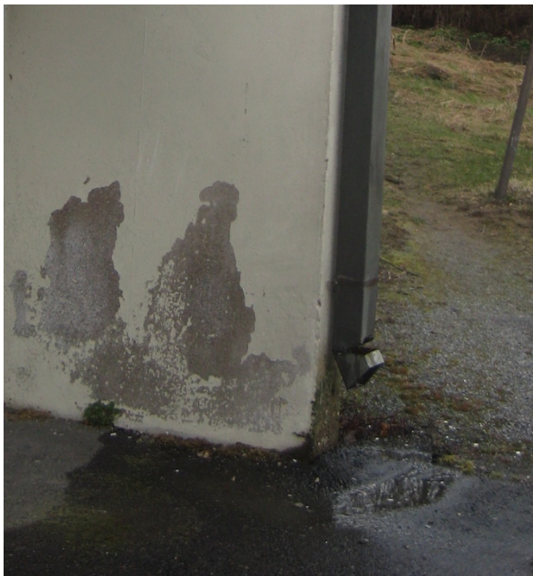
Kuva 4. Syöksytorvesta valuvaa vettä ei ole ohjattu mihinkään, vaan se lammikoituu seinää vasten ja nostaa betonin kosteusrasitusta voimakkaasti.
