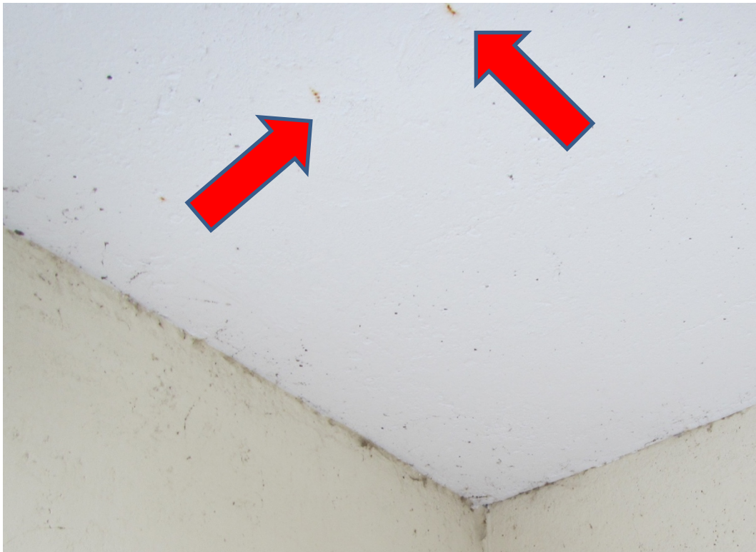
Kuva 6. Maalattupintaisen huoneistoparvekelaatan alapinnassa havaittavissa teräksistä valuvaa korroosiotuotetta
