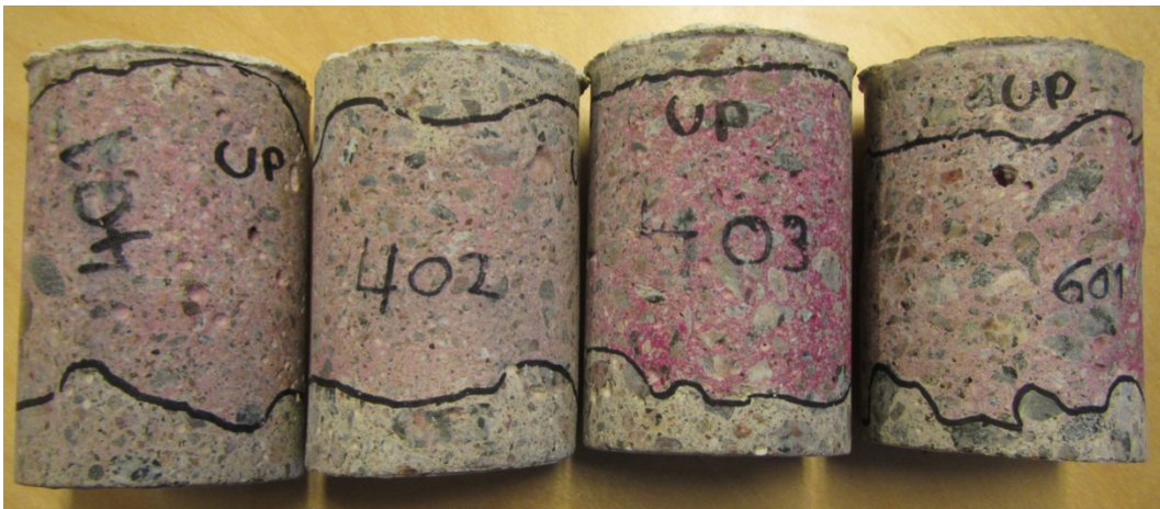
Kuva 13. Parvekekaiteista irrotetut betoninäytteet.
