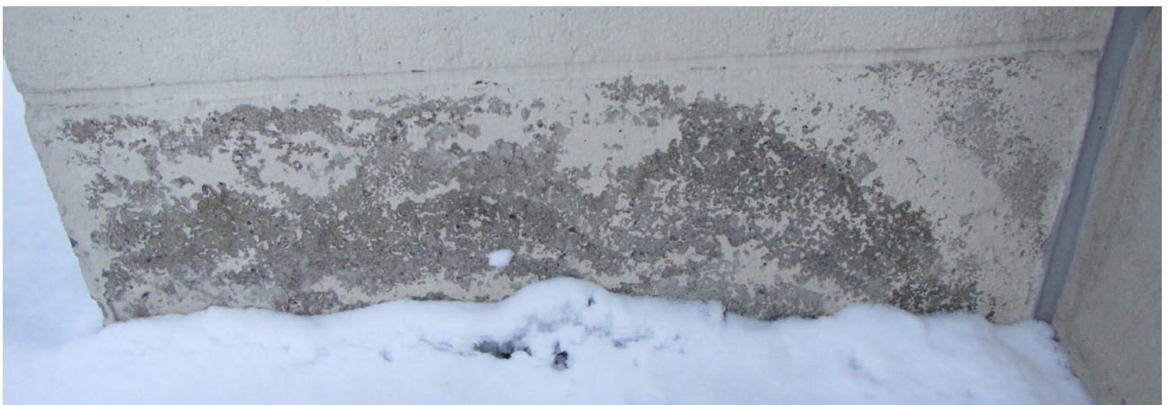
Kuva 2. Kellarikerroksen elementtien maalipinnassa voimakasta hilseilyä.
