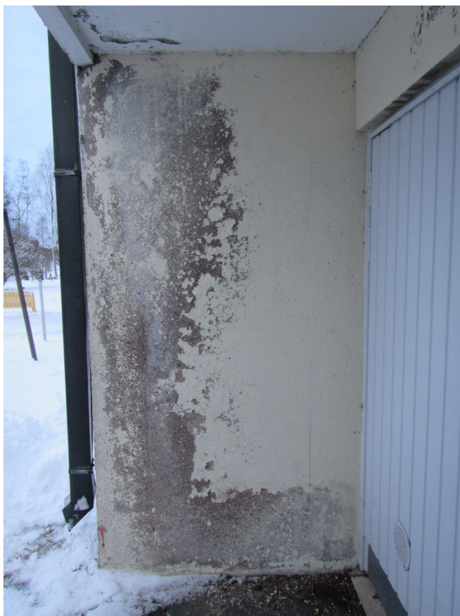
Kuva 8. Lännenpuoleisen parvekkeen pielessä havaittavissa pakkasrapautuman aiheuttamaa vaurioita
