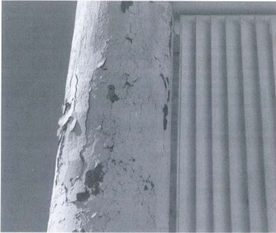
KUVA 3. Pakkasrapautuman aiheuttamaa vauriota betonissa (Betonijulkisivun kuntotutkimus 2013, 33)
