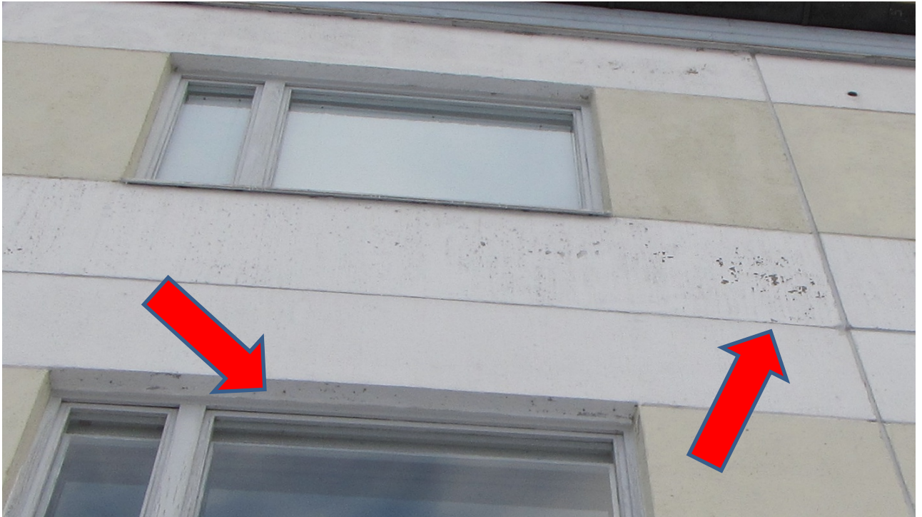
Kuva 1. Kohteen maalattupintaisten julkisivuelementtien vauriot ovat pääasiassa maalipintojen hilseilyä.
