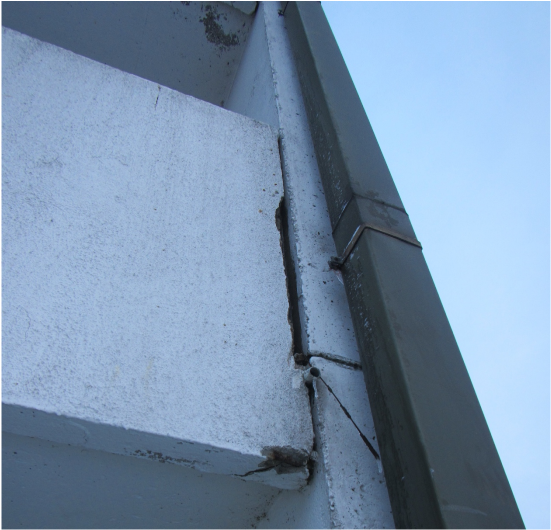
KUVA 7. Varsinkin parvekekaiteissa on paljon korroosiovaurioita.
