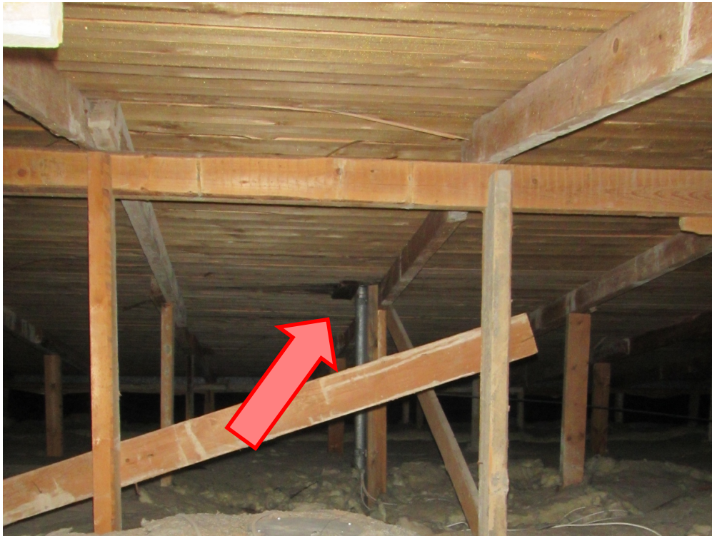
Kuva 15. Aluslaudoitus on pääosin siisti. Läpivientien yhteydessä on paikoin havaittavissa viitteitä kattovuodoista.
