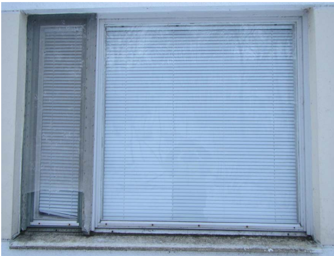
KUVA 8. Kohteen ikkunat ovat pääasiassa hyväkuntoiset. Vesipeltien kaadot ovat vähäisiä ja varsinkin pohjoisjulkisivulla on runsaasti orgaanista kasvustoa.
