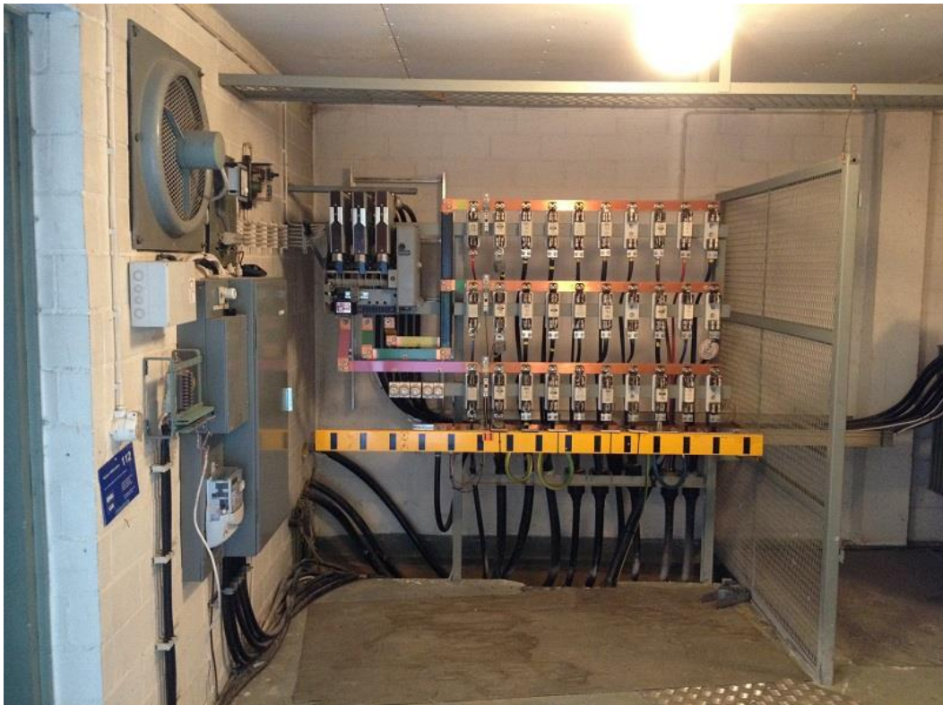
Kuva 10. Muuntamotila. Vasemmalla katuvalaistuskeskus ja keskellä pienjännitepuolen avokiskosto.
