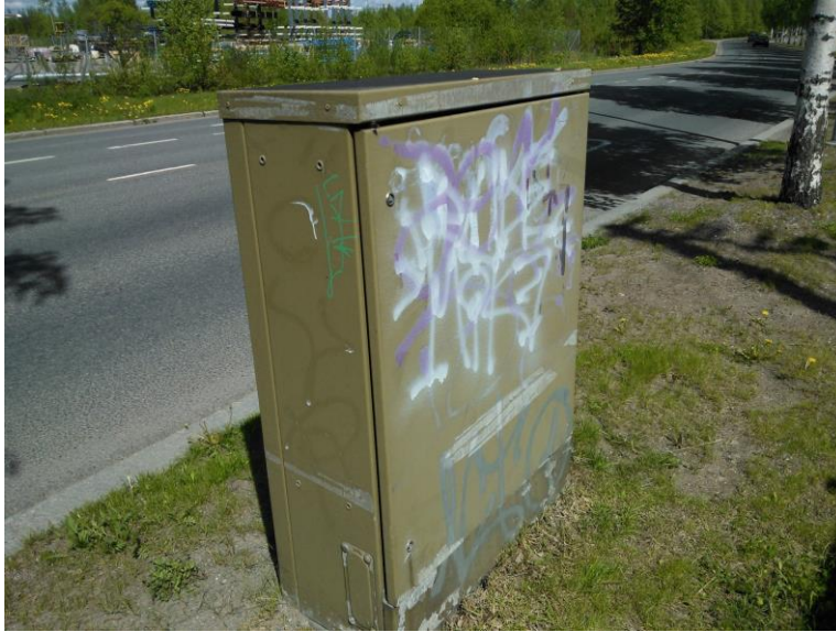
Kuva 11. Maantien vieressä oleva katujakokaappi (Lassila & Tikanoja 2015).
