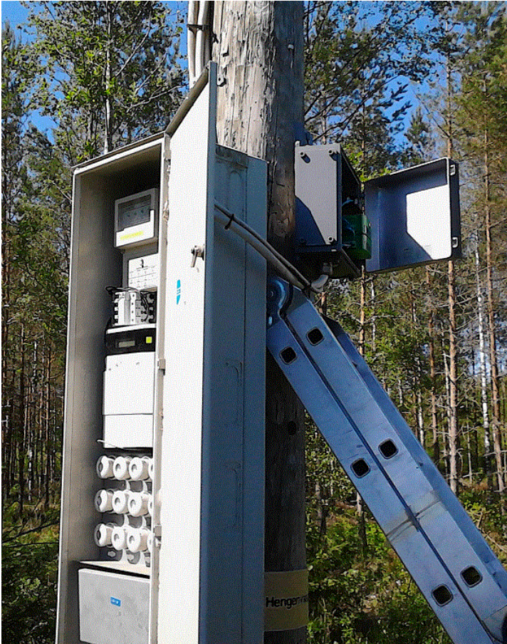
Kuva 12. Valaistuksen jakokeskus ja ohjausyksikkö pylväässä (Lassila & Tikanoja 2015).
