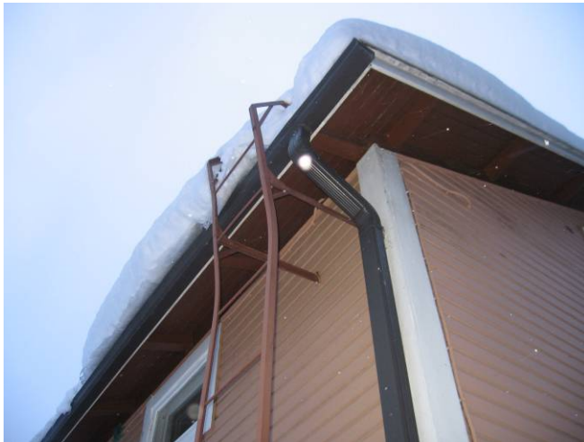
Kuva 20. Katolle menevät tikkaat eivät ole kunnolla kiinni.
