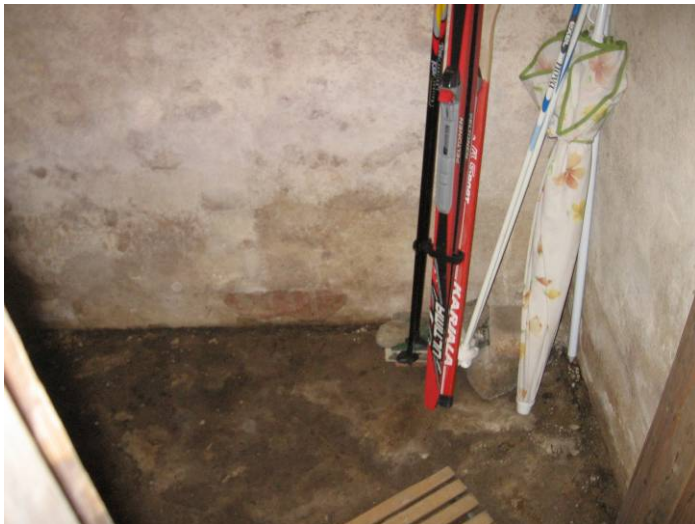
Kuva 35. Vanhan osan kellarin märkä lattia.
