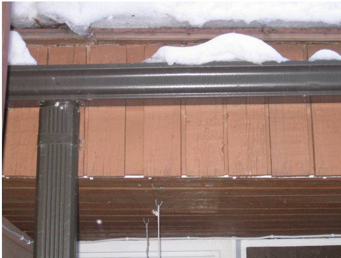
Kuva 23. Vesikouru on asennettu virheellisesti.
