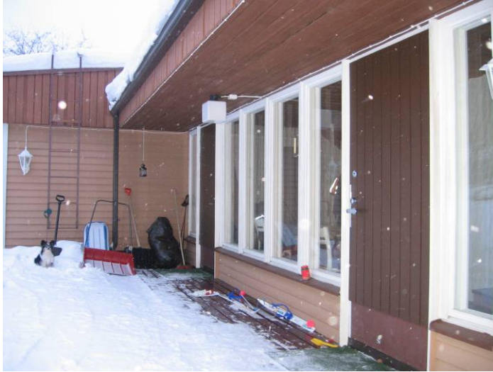
Kuva 22. Sadevettä ei ohjata pois syöksytorvesta.
