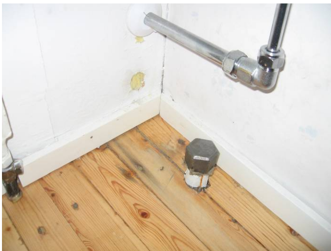
Kuva 51. Makuuhuoneessa oleva vesijohto.
