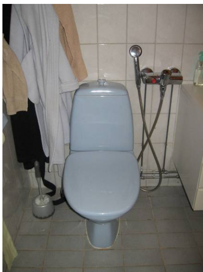
Kuva 48. Vessanpöntön vieressä oleva suihku tiputtaa vettä.
