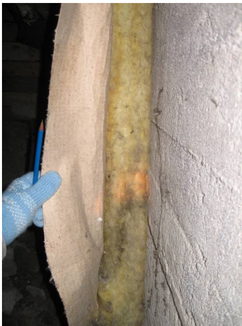
Kuva 5. Tummunutta mineraalivillaa sokkelin vieressä.
