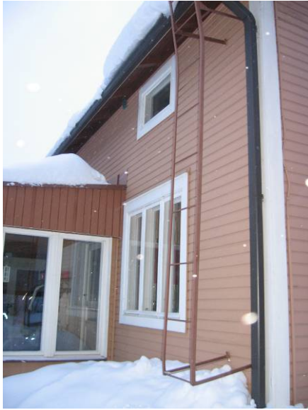
Kuva 25. Syöksyturvista ei ole sadevesien ohjausta pois.
