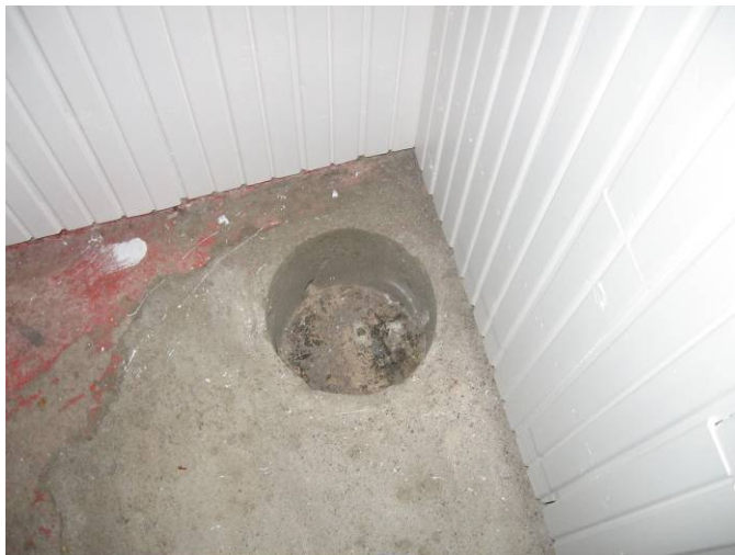
Kuva 38. Pukuhuoneen lattiassa reikä.
