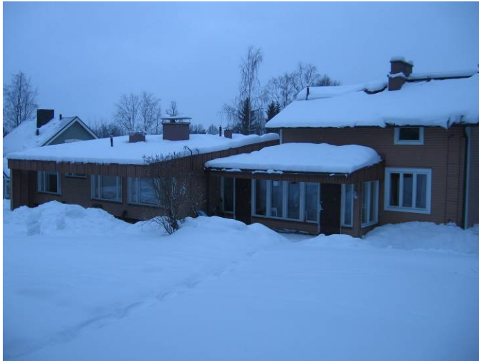
Kuva 16. Laajennuksen päädyssä ei ole tuuletussäleikköä.
