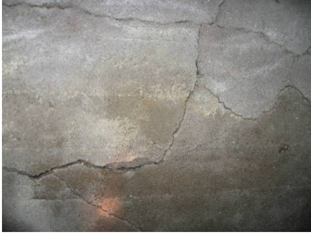
Kuva 7. Routimisesta aiheutuneita halkeamia.
