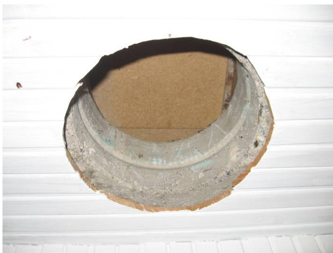
Kuva 39. Pukuhuoneen katossa reikä.
