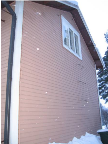
Kuva 17. Rintamamiestalossa ei ole yläpohjassa tuuletussäleikköä.
