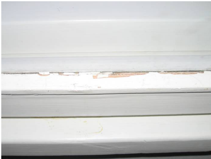
Kuva 50. Makuuhuoneen ikkunan maalipinta hilseillyt.
