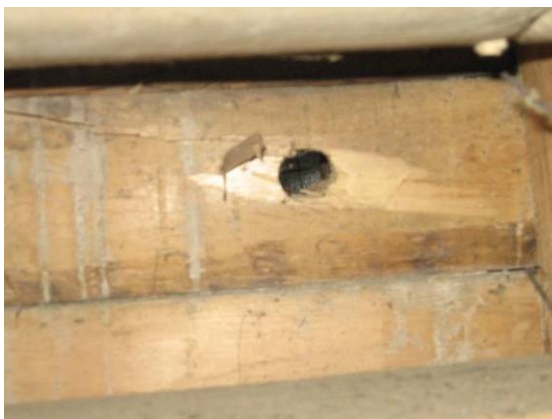
Kuva 3. Puutteellinen tuuletusreikä alapohjassa.
