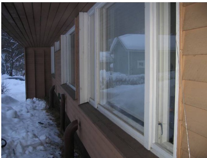
Kuva 27. Sadevesi valuu katolta rakennuksen eteen.
