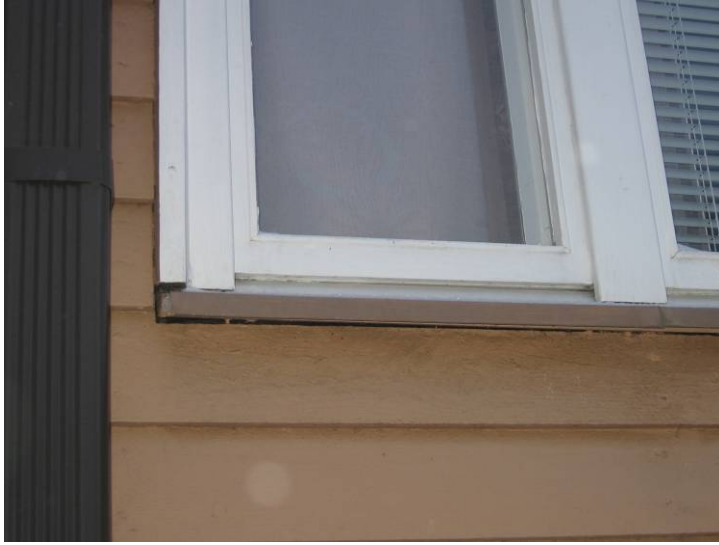
Kuva 28. Ikkunapellityksistä puuttuu sivulle nostot.
