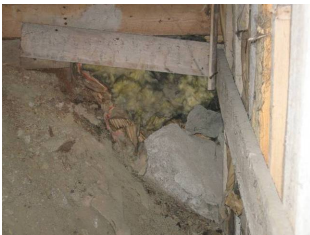
Kuva 6. Tummunutta mineraalivillaa alapohjassa.
