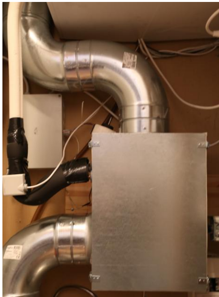
KUVA 4. Huonetuloilman lämmönvaihtimen laatikko putkistoineen
