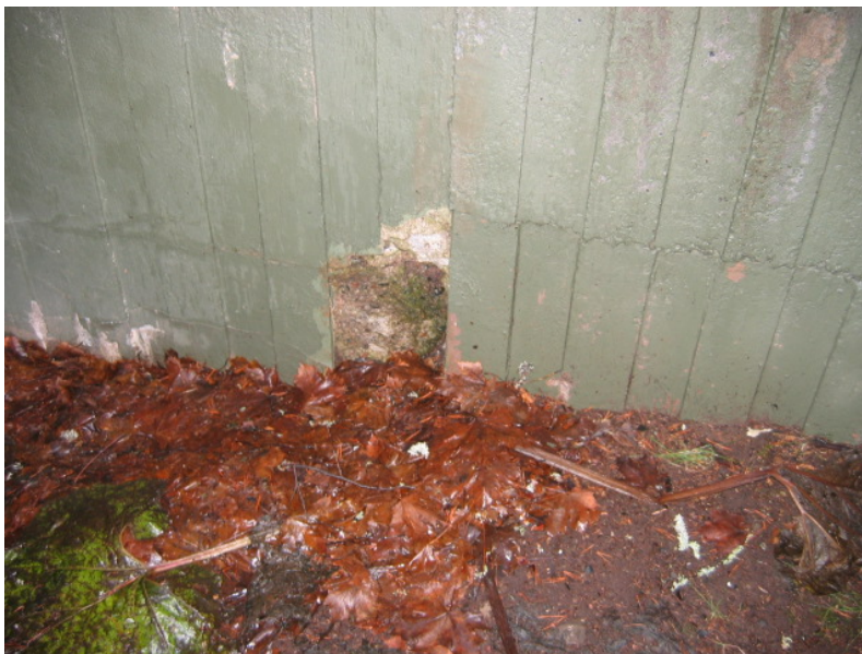
Kuva 9. Sokkelissa on pakkasvaurion aiheuttamaa rapautumista.
