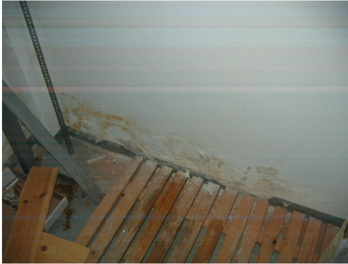
Kuva 4. Sähköpääkeskuksen seinän alaosassa on selvästi havaittavissa kosteuden aiheuttamia vaurioita.
