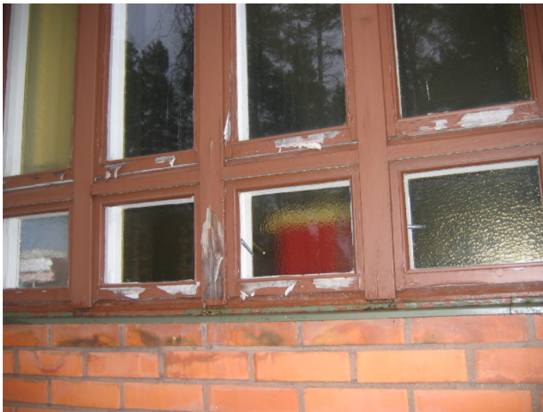
Kuva 10. Ikkunakarmeissa ja -pokissa maali on hilseillyt ja on havaittavissa lahovaurioita.
