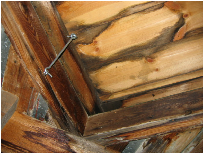
Kuva 12. Paloluukussa ja luukun ympärillä on vesivaurion aiheuttamia jälkiä ja lahovaurioita.
