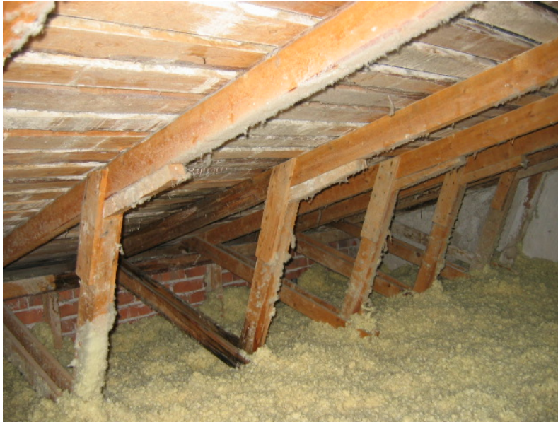
Kuva 11 Kattopalkissa ja palkkia kannattavassa pukissa on havaittavissa vesivaurion aiheuttamia jälkiä.
