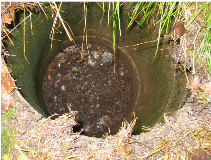
Kuva 8. Sadevesikaivo, kaivon pohjalla n. 30 cm roskia ja maa-ainesta.
