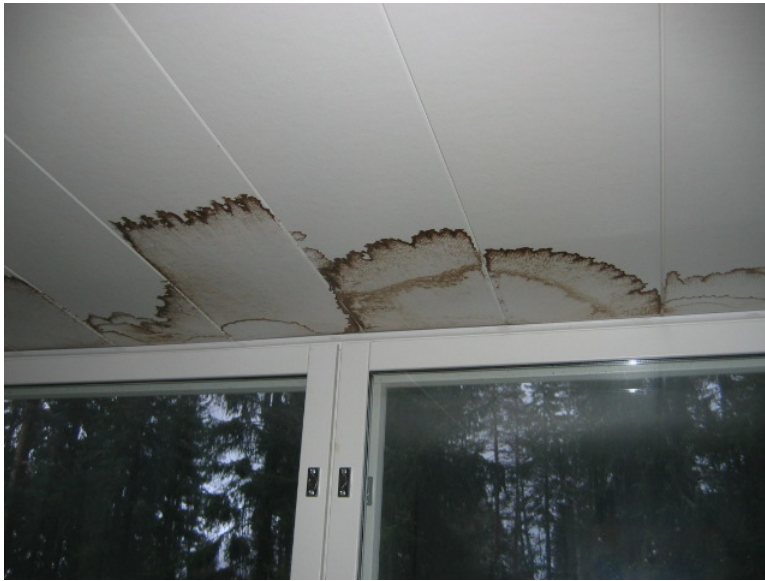
Kuva 1. Vesivauriojälkiä porraskäytävän katossa.
