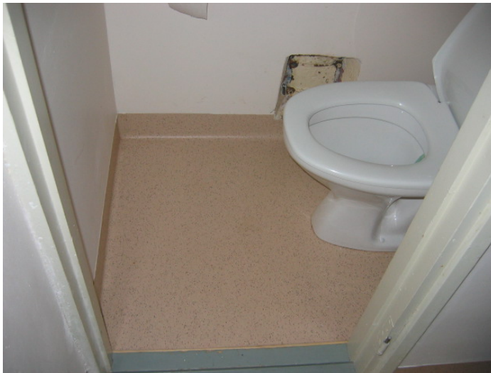
Kuva 5. Wc:n lattiassa matto on irti alustasta.
