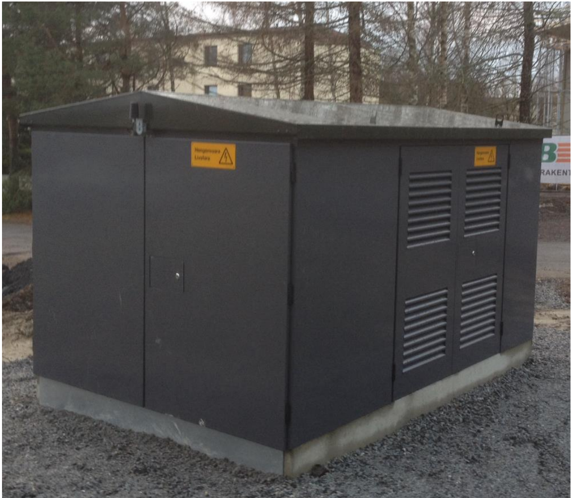
Kuva 3. Harju Elekterin valmistama kaukokäyttömuuntamo
