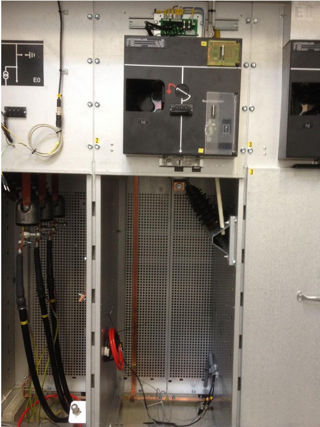
Kuva 5. Schneider Electricin kojeisto kuvattuna KL Industrin tehdasteissä
