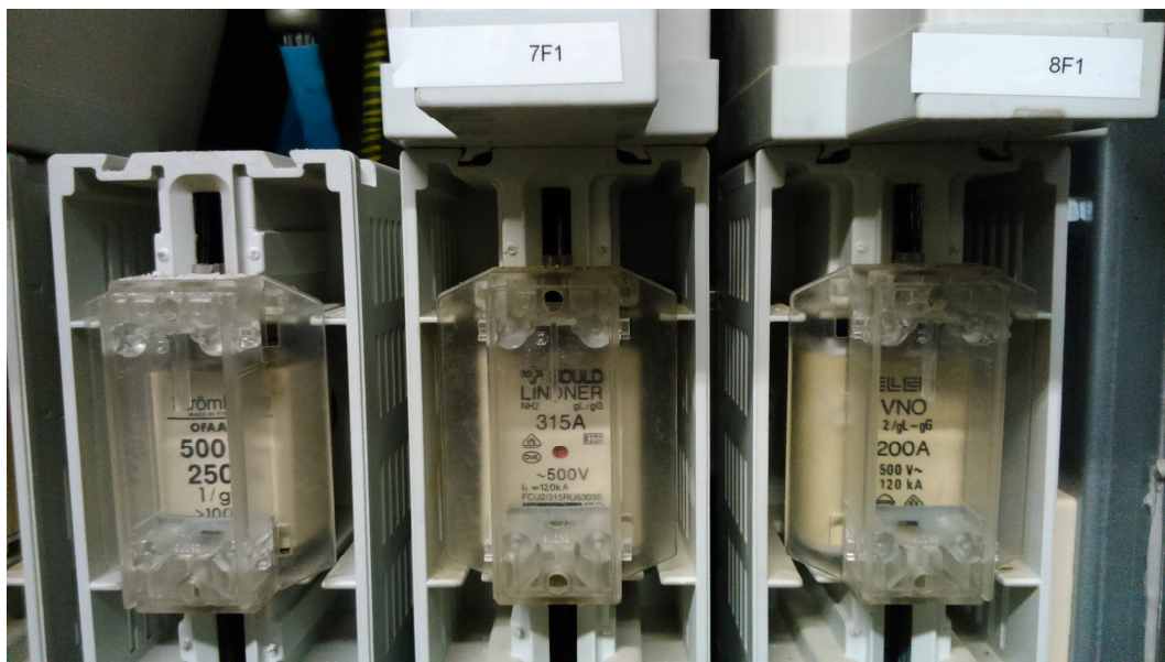
Kuva 5. Pääkeskuksen lähdöt 6, 7 ja 8, sekä niiden kahvasulakkeet.
