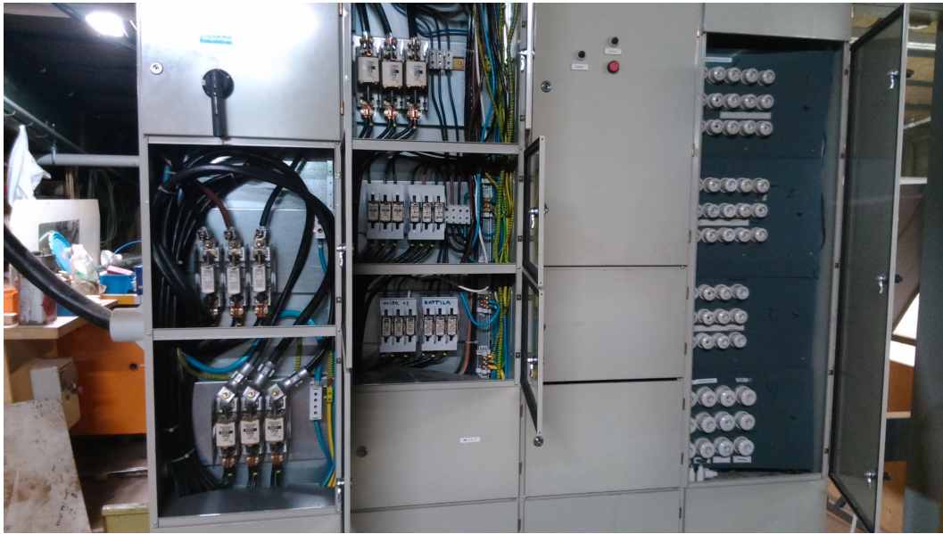
Kuva 3. Hiipakan tehtaan ryhmäkeskus RK1.
