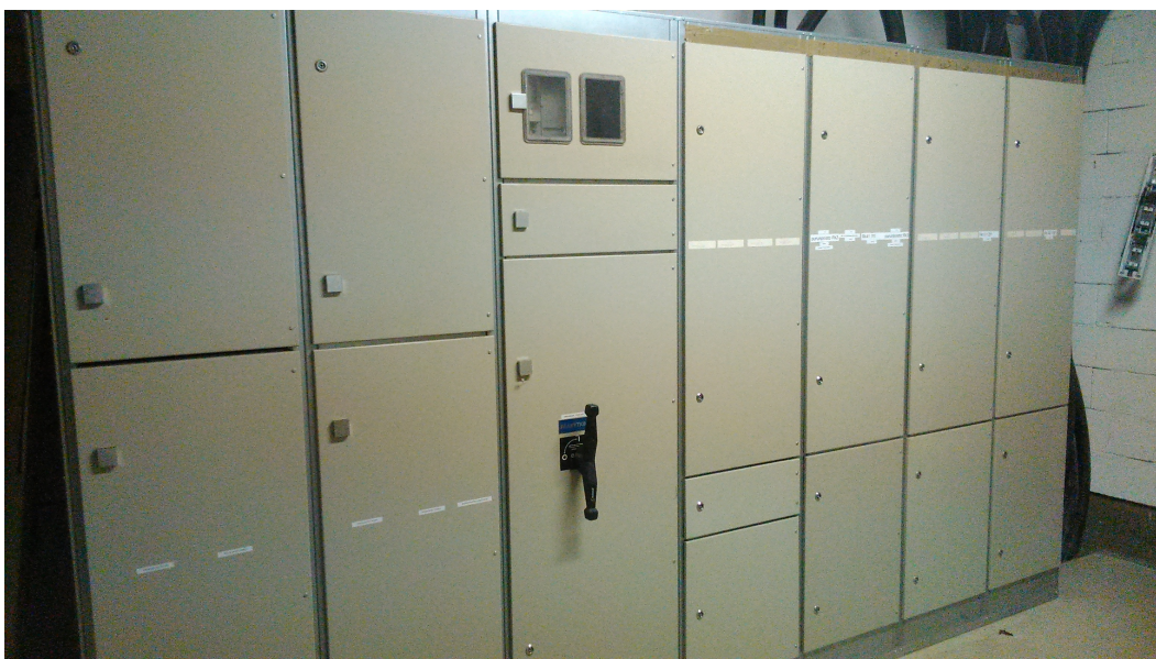
Kuva 2. Hiipakan tehtaan sähköpääkeskus PK1.
