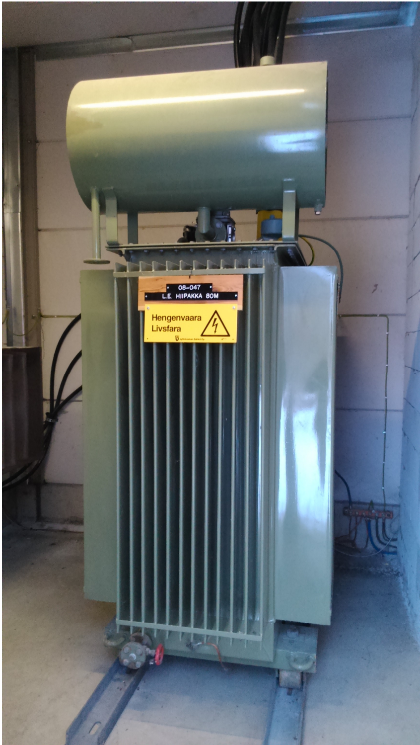
Kuva 1. E J Hiipakka Oy:n 20 kV / 400 V muuntaja
