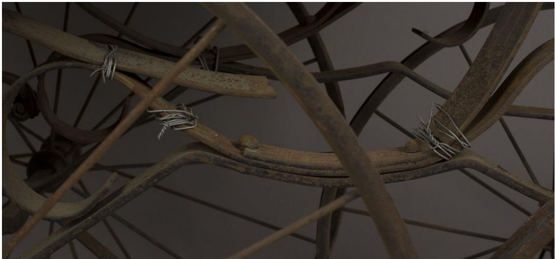
Kuva 8. Rungon katkenneita rautaosa on yritetty kiinnittää metallilangoilla.
