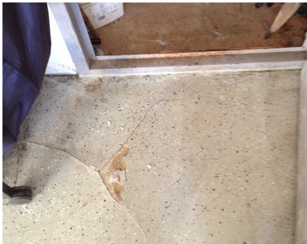
KUVA 6. Lohkeama pinnoitteessa palo-oven edustalla
