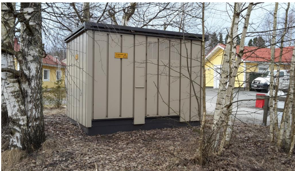
Kuva 8. Puistomuuntamo Sääksmäen pohjavesialueella.
