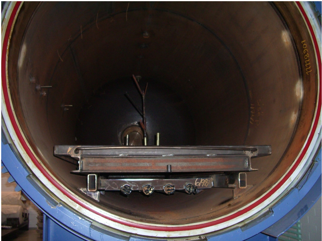
Kuva 8. Sähkövastukset vaunukiskojen alapuolella.
