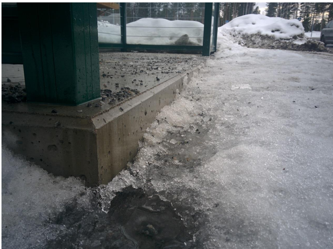
KUVA 12. Petosentie -pysäkin uuden pysäkkikatoksen suunnittelu- tai rakennusvaiheessa ei ole huomioitu pysäkkivarusteiden esteettömyysvaatimuksia, sillä kuvassa näkyvän kynnyksen takia pyörätuolia käyttävän henkilön on mahdotonta päästä kesällä katoksen sisälle. (Lappalainen 2016)
