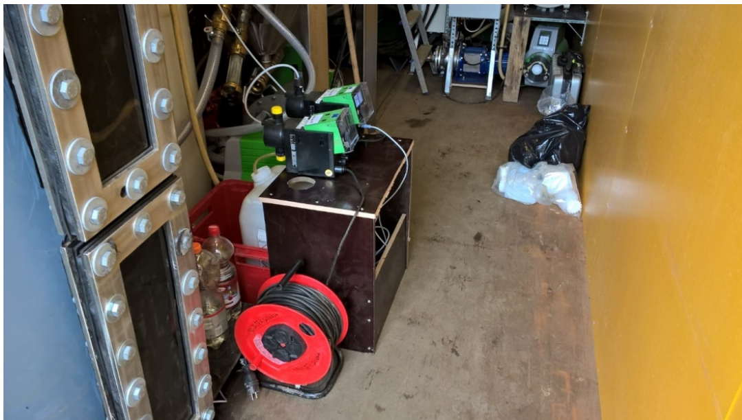
Kuva 16. Neutralointikemikaalin annostelupumppu (Kuhmonen, 2016)
