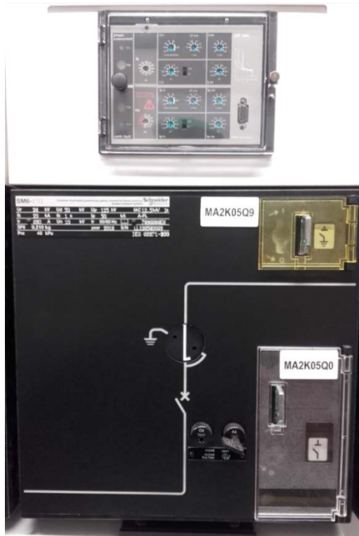
KUVA 5. Katkaisija. Kuvan ylälaidassa releistykseen asettelu. (Väisänen, 2016)
