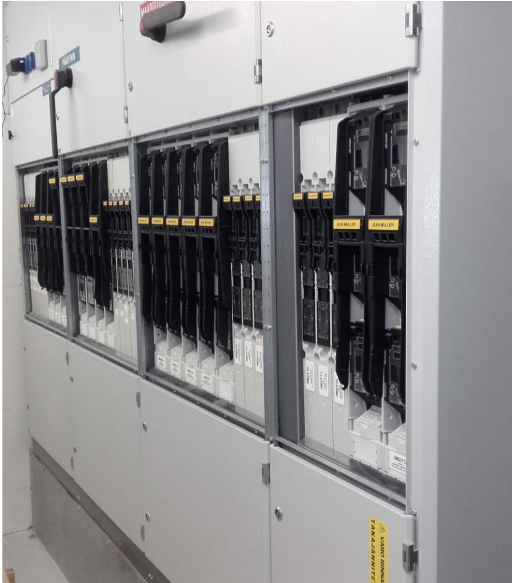
KUVA 9. MA2 muuntajan 2 syöttämä pääkeskus 2PJ2. (Väisänen, 2015)
