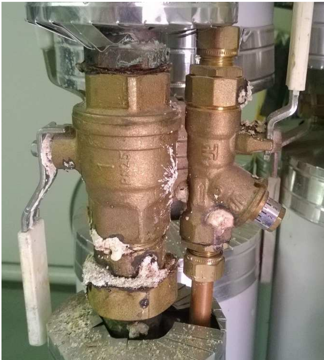
Kuva 8. Alle 5 vuotta vanhat venttiilit Rauman kaupungin kiinteistöissä, oikeanpuoleisessa venttiilissä näkyy STF- tyyppihyväksyntämerkintä.
