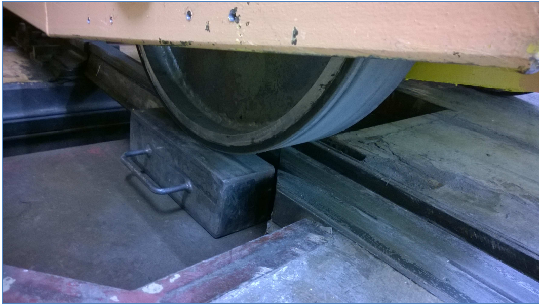
Kuva 8. Ajolaitteen vasen pyörä kynnyksen ongelmakohdassa.
