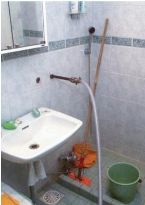
Kuva 9. Saneerausliitin ja siihen kytketty paineilmaletku
