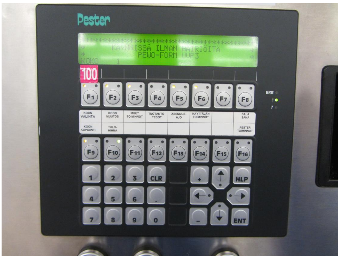
Kuva 9. Valvomoa luodaan WinCC -Flexible ohjelmalla, jota ohjataan näppäimistöllä ja hiirellä.
