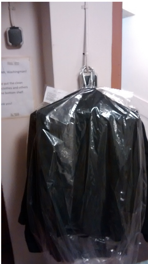
Kuvio 3: Sähköjohtoa väärinkäytetään vaatteiden ripustamiseen.
