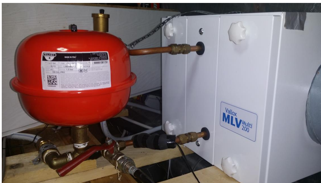
Kuva 11. Järjestelmää suojaamaan valittu kalvopaisunta-astia.
