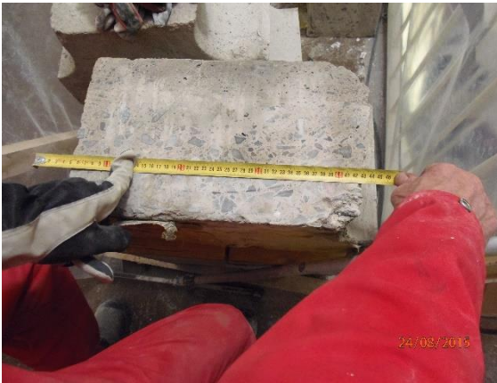
KUVA 6. Sahattu välipohjalaatan palanen
