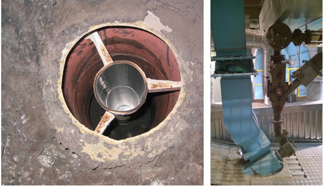
Kuva 11. Pölypoltin kattilan sisältä ja ulkoa (Voimalaitoksen arkistokuvat)
