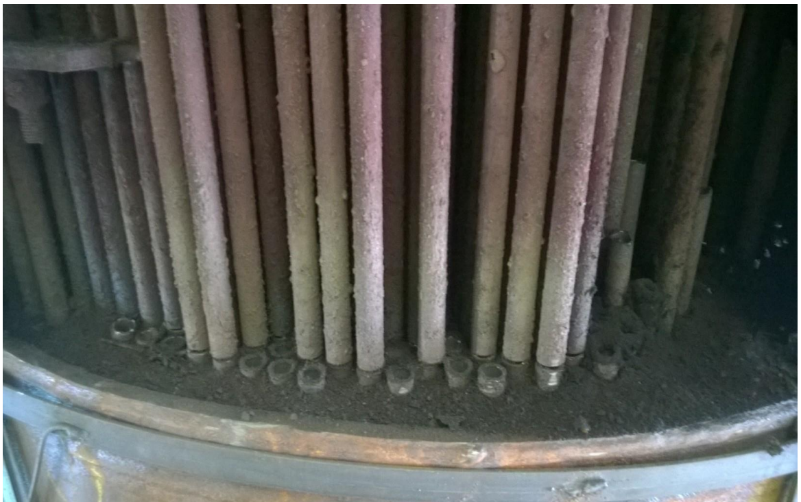
Kuva 2 Lämmönvaihtimeen muodostunutta korroosiota
