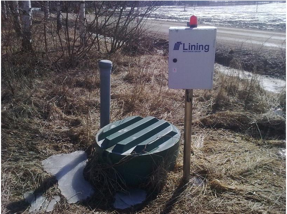
Kuvio 2. Vesiosuuskunnista kolme huolehtii talousveden toimittamisen lisäksi jäteveden viemäröinnistä. Kuvassa jätevesipumppaamo Saarijärven Tarvaalassa.
