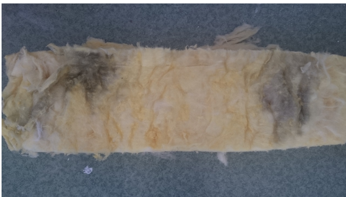
KUVA 6. Avatussa tarkastuskohdassa tummunut lämmöneriste (23.2.2016 Haapakorpi)
