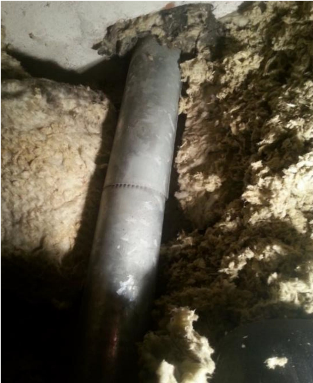
KUVA 15. Eristämätön ja kiinnittämätön tuuletusputki yläpohjassa
