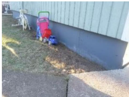
KUVA 5. Maanpinta viettää rakennukseen päin
