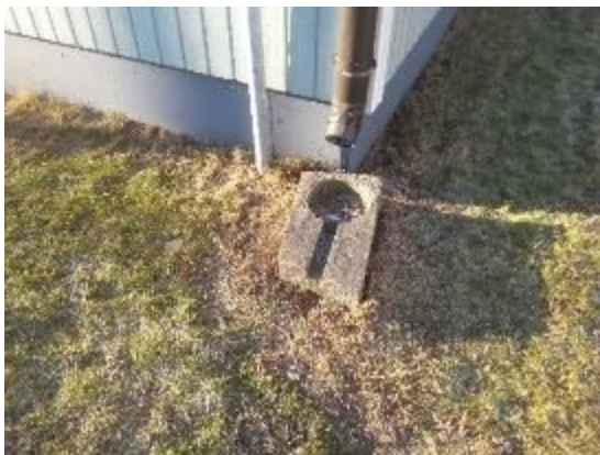
KUVA 4. Sadevesijärjestelmän puutteesta johtuen katolta tuleva vesi jää rakennuksen viereen
