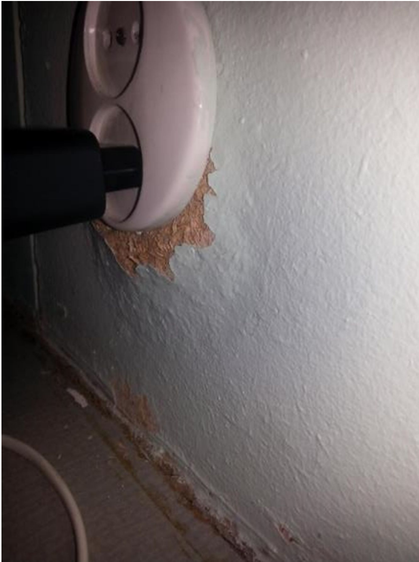
KUVA 13. Kosteusvaurio sähköpistokkeen läpiviennin ympärillä
