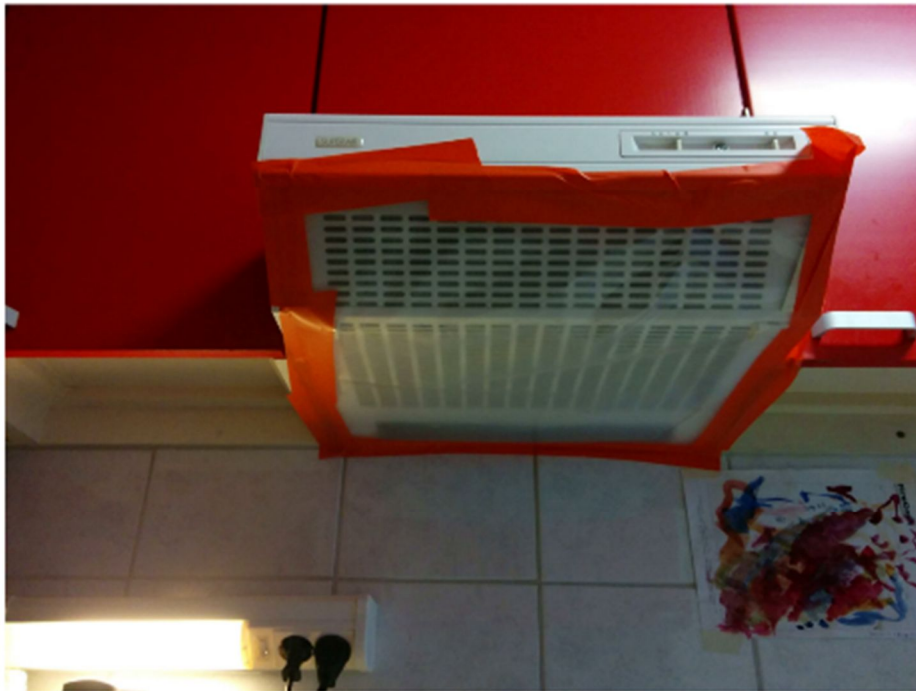
Kuva 4. Liesituuletin tukittu muovin avulla.
