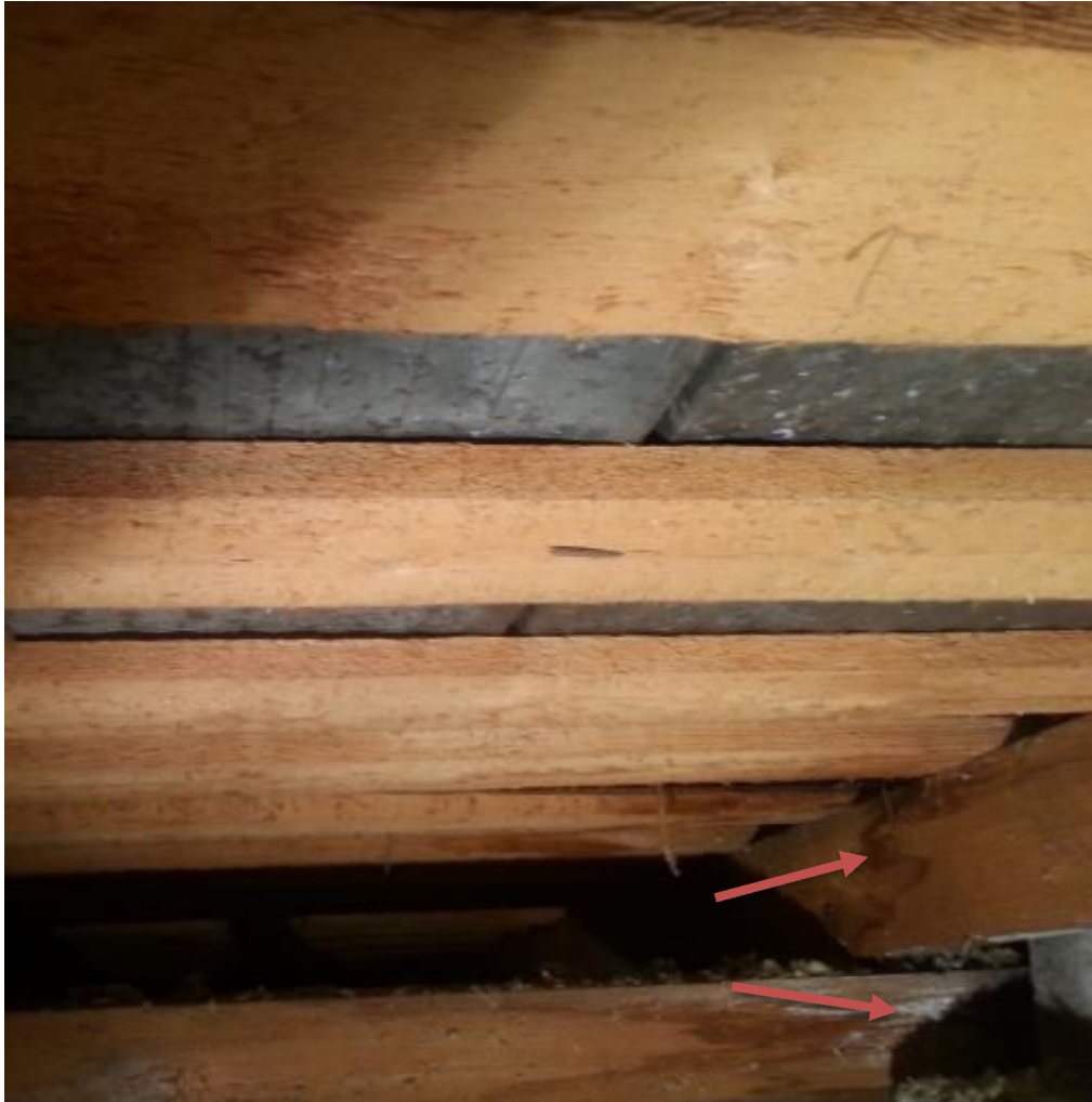
KUVA 14. Kosteuden aiheuttamia jälkiä puurakenteissa
