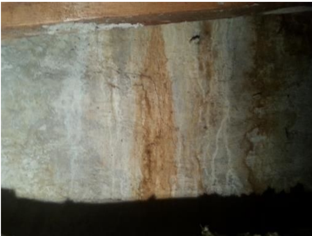
KUVA 17. Kosteusjälkiä savupiipun kyljessä
