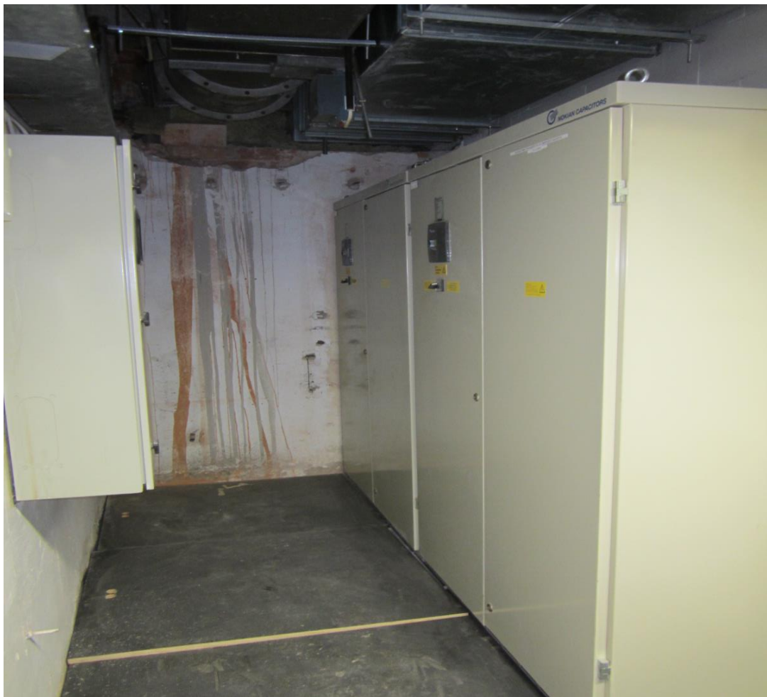
Kuva 4. Automaattinen kompensointilaitteisto kuvassa oikealla. Laitteiston pystyy sijoittamaan melko ahtaaseen väliin.
