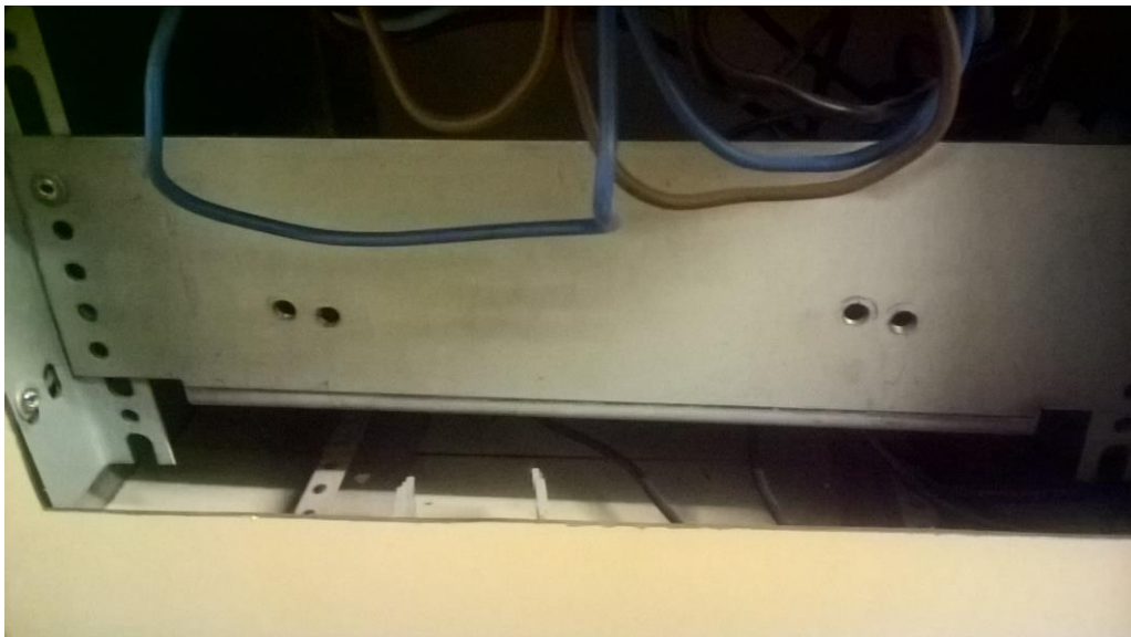
Kuva 4. Pahvista tehty putoamissuojaus.
