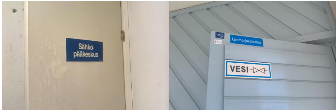
Kuva 5. Sisällä väliovessa oli kyltti sähköpääkeskustilasta, mutta ulko-ovessa ei ollut opastetta.
