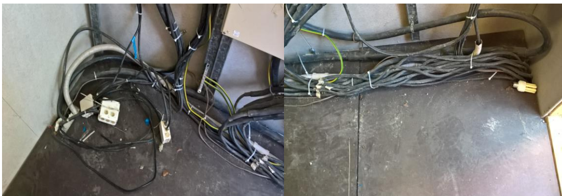
Kuva 8. Huonosti asennetut ryhmäjohdot.
