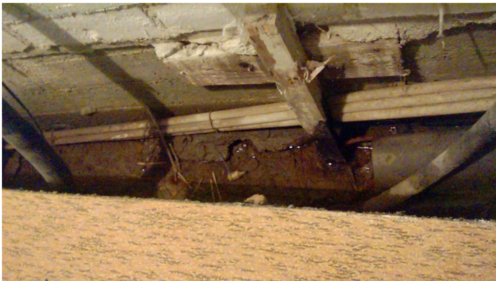
Kuva 11. Kaapelit ovat veden alla.
