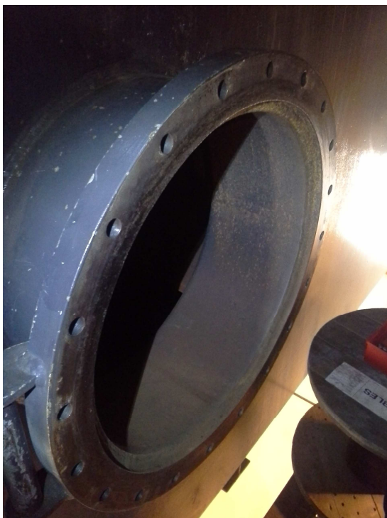
Kuva 2. Lauhduttimen säilöntäluukku avattuna, kuvassa näkyy pulttikehän reiät ja tiivistepintaa. (Alm 2014)
