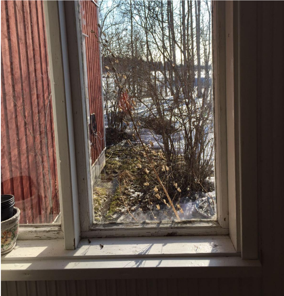
KUVA 12. Kylmän eteisen ikkunoiden kuntoa sisäpuolelta
