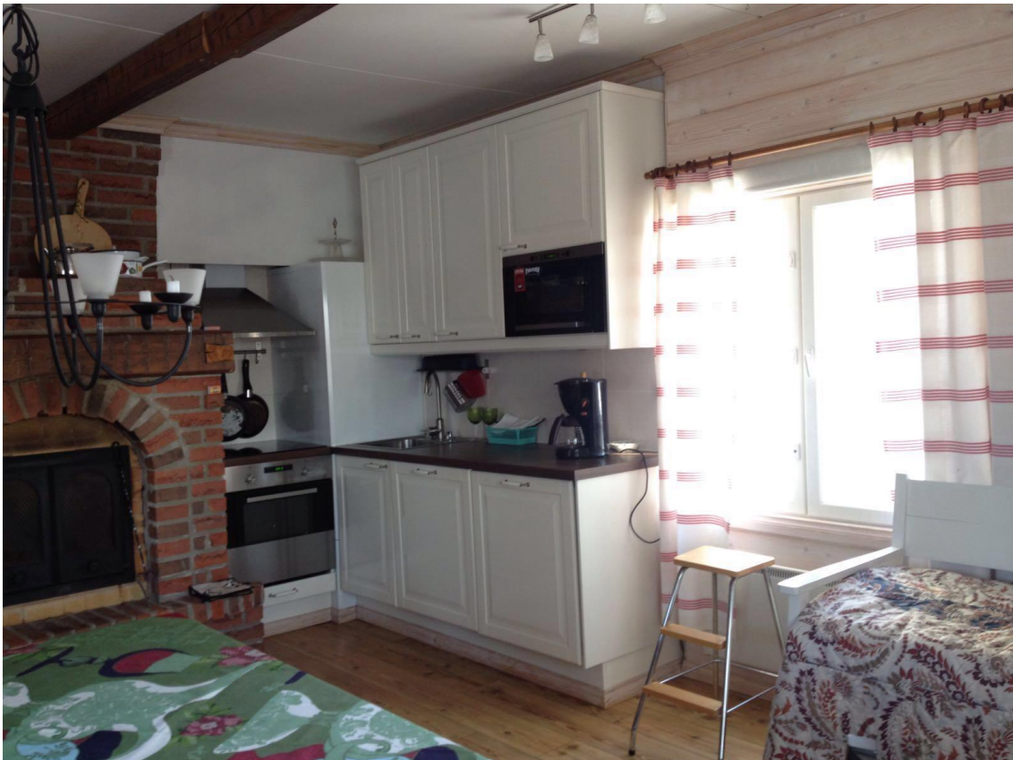
KUVA 19. Kuvassa näkyy tulisijan nokeentunut luukku ja etuosa, sekä tupakeittiön sisäpintoja ja -tiloja
