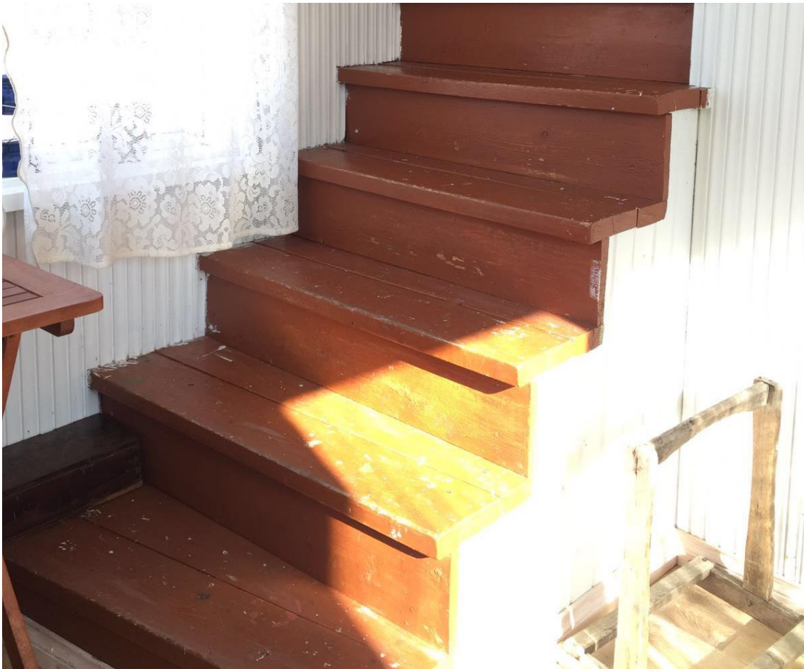
KUVA 16. Yläkertaan johtavat portaatt ovat puhtaalla maalipinnalla, joten ne ovat liukkaatt
