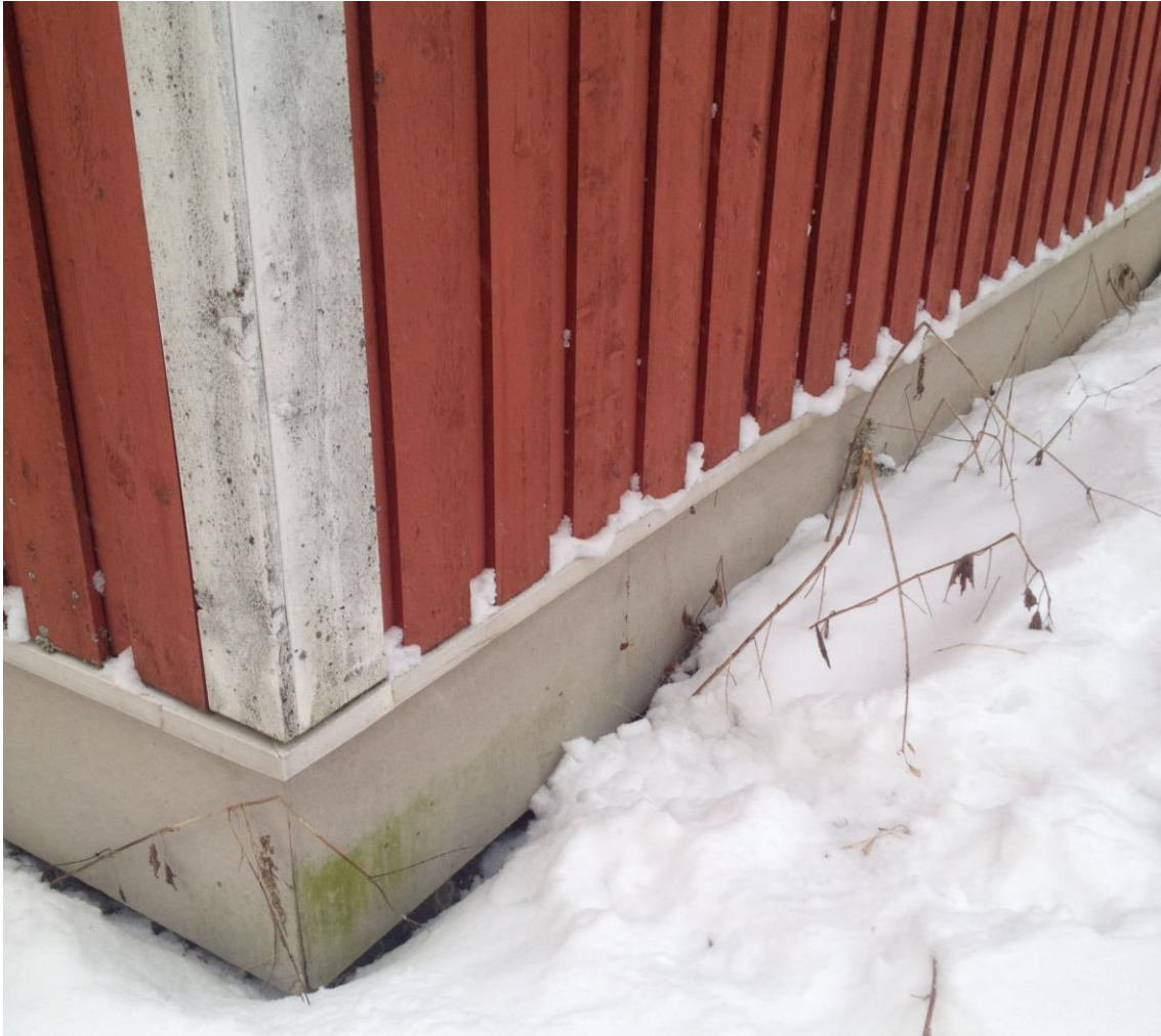
KUVA 10. Sokkelilevyjen vaurioita ja ulkovuorauksen kuntoa
