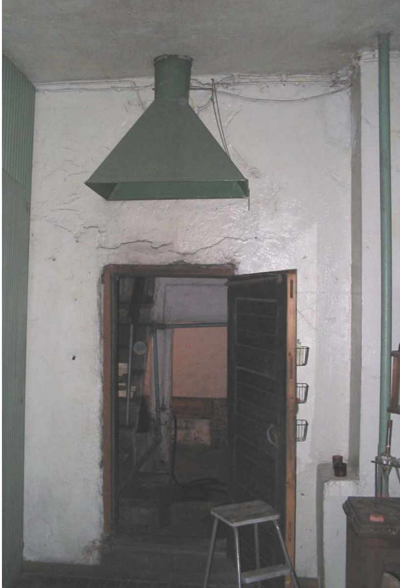
Kuva 32. Naisten pukuhuoneen harac-kamina
