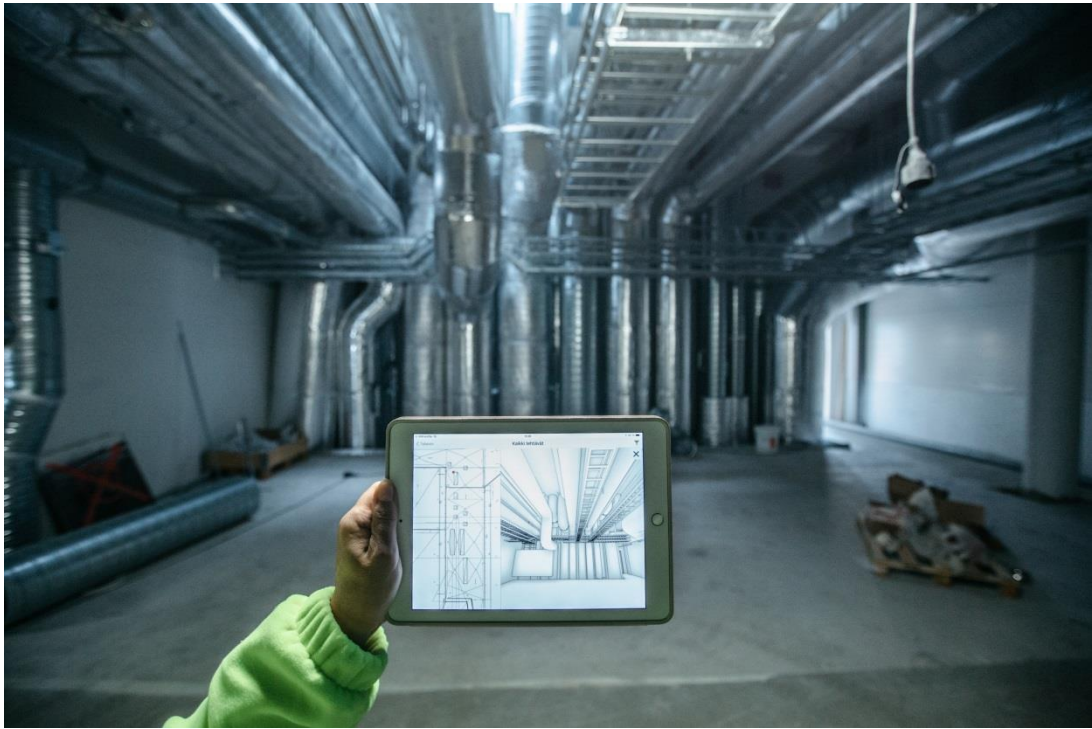
Kuva 6: Työmaalla Daluxin näkymä tabletilla katseltuna
